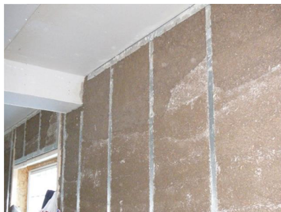
Εικόνα 19.: Εσωτερική απεικόνιση των εξωτερικών τοίχων μετά την τοποθέτηση της ασβεστοκάνναβης, (Picture: R. Kilman)
