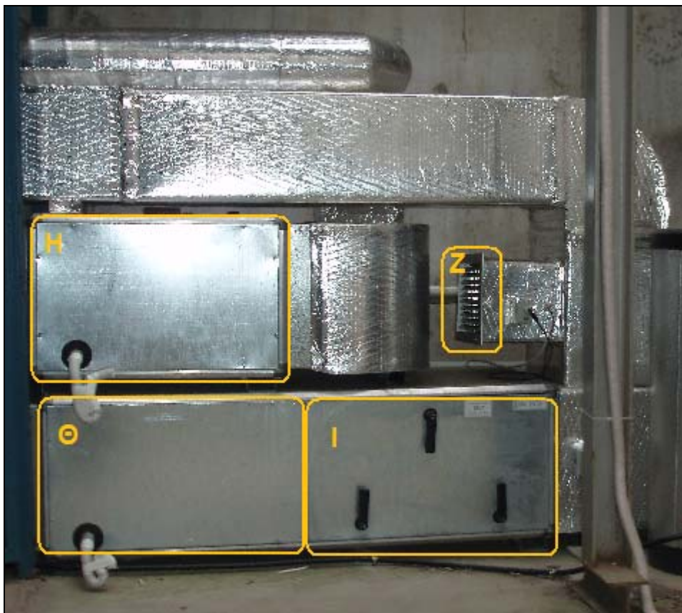
Σχήμα 3.19: Κύκλωμα αέρα, (Z)Στόμιο αναρρόφησης αέρα περιβάλλοντος, (H)Στοιχείο μετάψυξης, (Θ)Στοιχείο πρόψυξης, (I)Φίλτρα του αναμεμιγμένου αέρα περιβάλλοντος και ανακυκλοφορίας
