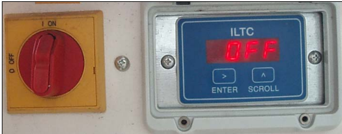
Σχήμα 3.28: Κεντρικός διακόπτης ισχύος(αριστερά) και πίνακας ελέγχου της αντλίας θερμότητας(δεξιά)
