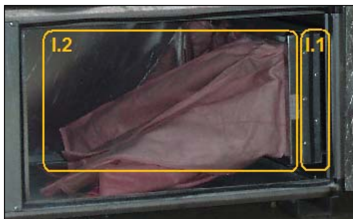
Σχήμα 3.17: Φίλτρα του αναμεμιγμένου αέρα πριν το στοιχείο πρόψυξης τοποθετημένα στην εγκατάσταση, (Ι.1)Πρόφιλτρο Z, (Ι.2)Σακόφιλτρο
