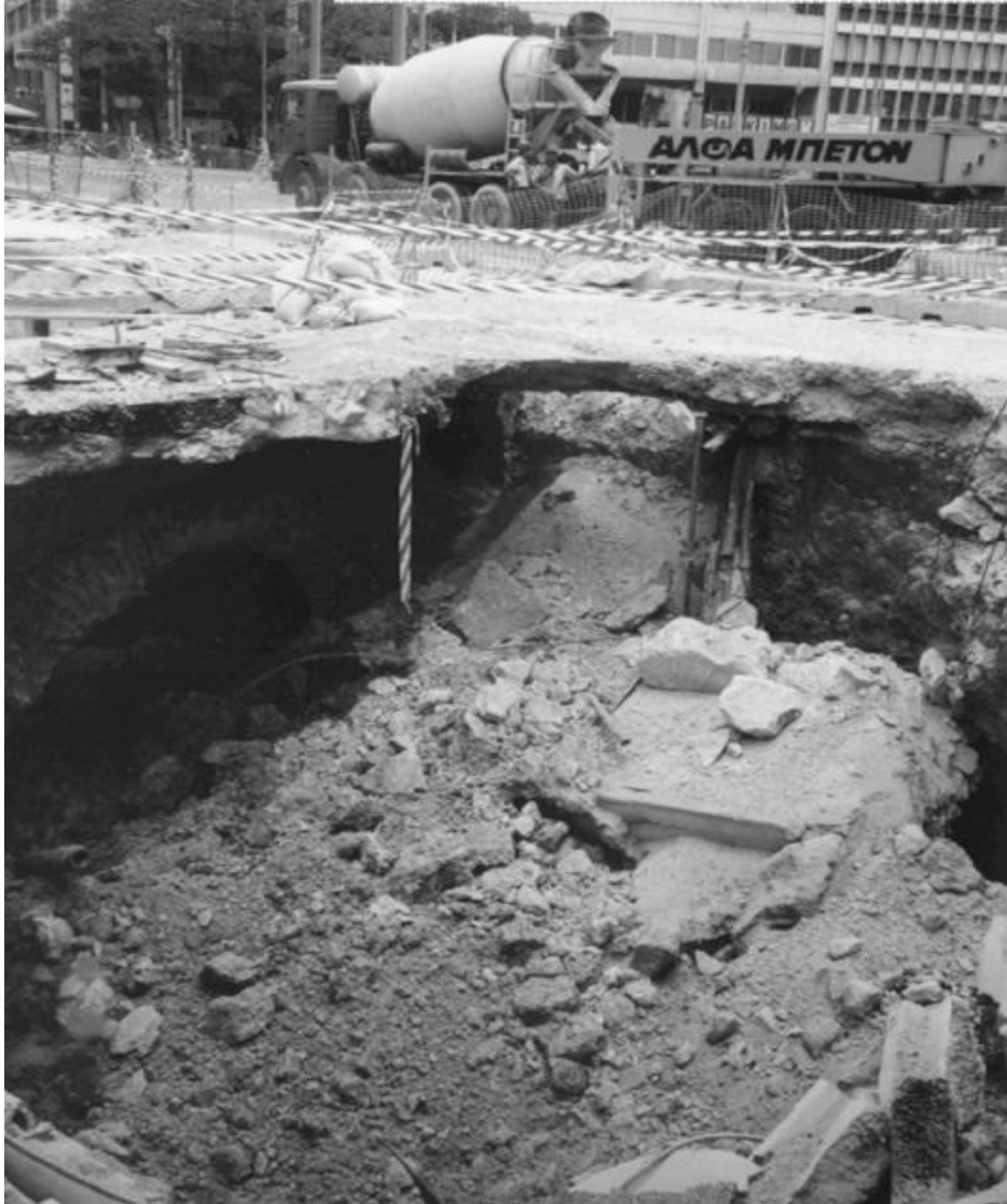
Εικόνα 3.2: Αστοχία στην πλατεία Καραϊσκάκη λόγω φαινομένου καμινάδας πάνω από το μέτωπο της σήραγγας του Μετρό Αθηνών (Τσαπέκης, 2019)
