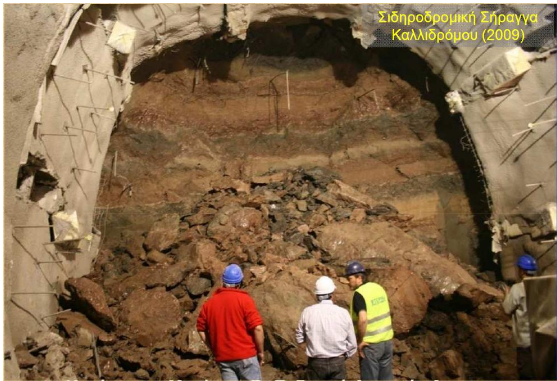
Εικόνα 3.5: Αστοχία μετώπου σιδηροδρομικής σήραγγας Καλλιδρόμου (Καββαδάς,2012).
