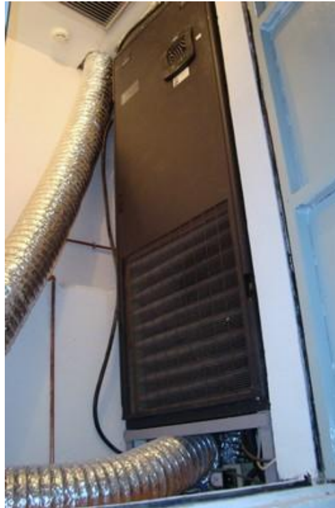
Εικόνα 15 Μονάδα κλιματισμού για τη διατήρηση των επιθυμητών συνθηκών εντός της αίθουσας ελεγχόμενων συνθηκών. (Φωτογραφία από το site του εργαστηρίου)
