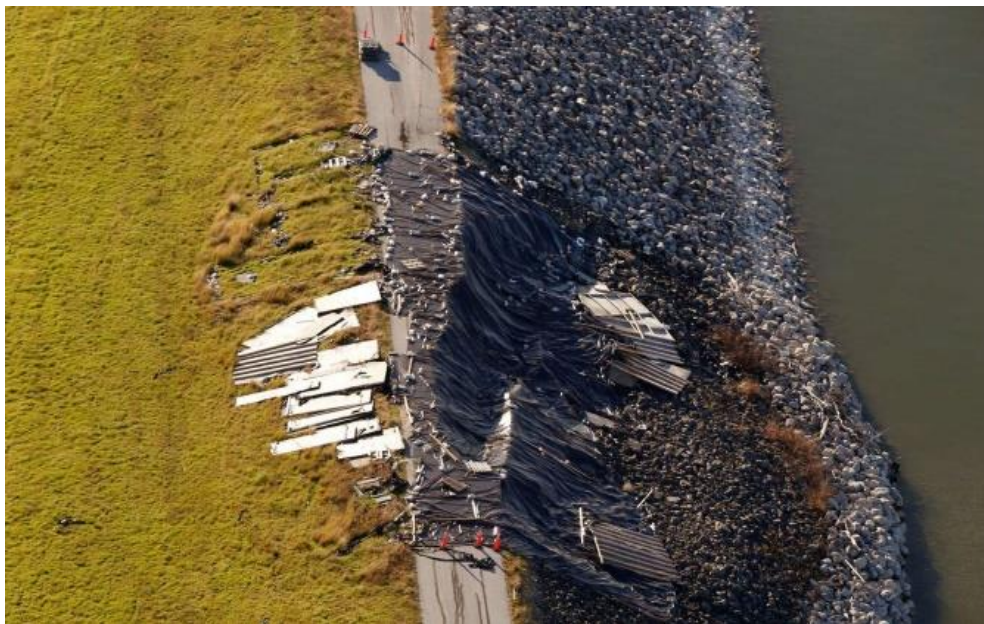
Εικόνα 2.18: Φράγμα μετά από ολίσθηση πρανούς
