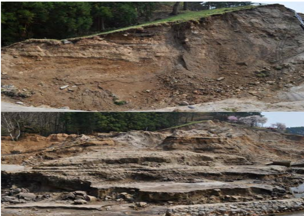
Εικόνα 2.30 : Αστοχία στο σώμα του φράγματος (πάνω) και στο δεξιό του αντέρεισμα (κάτω) (Πηγή: http://www.vncold.vn )
