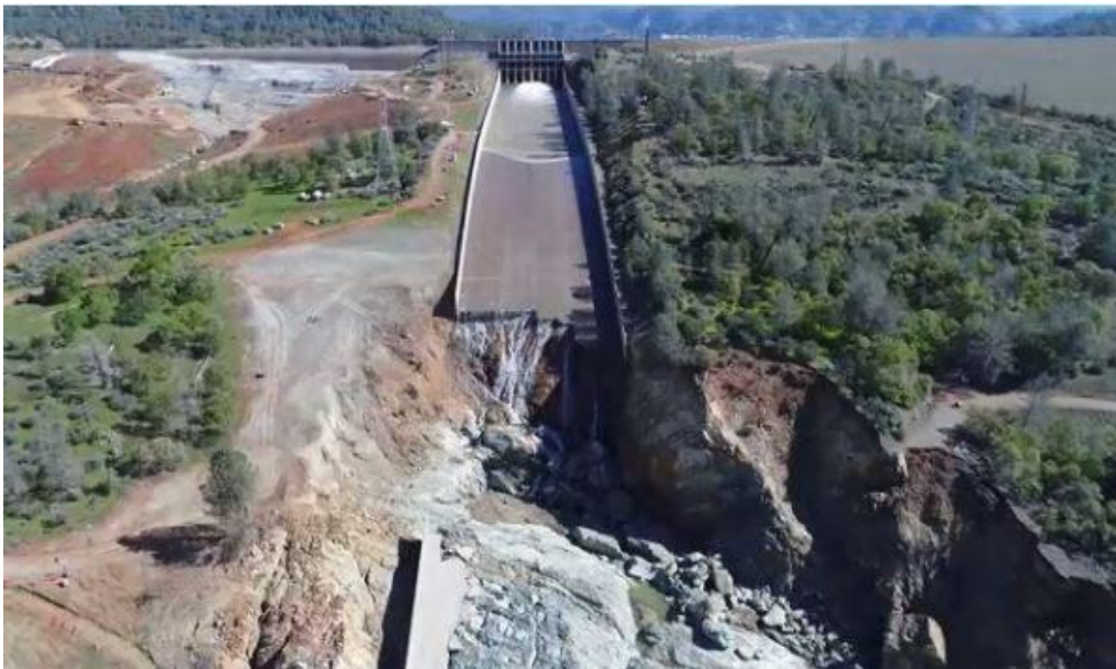
Εικόνα 2.15: Αστοχία λόγω προβλημάτων θεμελίωσης
