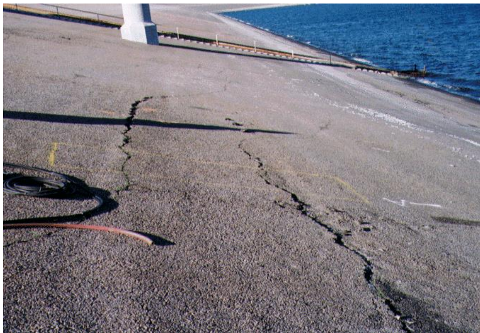
Εικόνα 2.36 : Μικρής έκτασης αστοχία από τον σεισμό Northridge στο νέο φράγμα San Fernando το 1994
