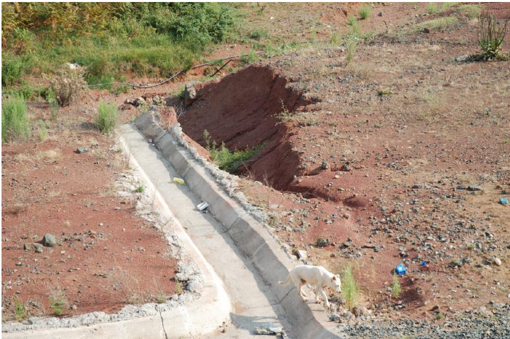
Εικόνα 2.14: Προβλήματα εσωτερικής διάβρωσης
