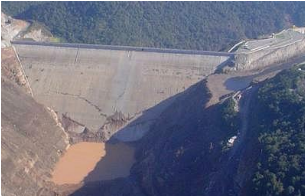
Εικόνα 2.19: Ρωγμή σε φράγμα
