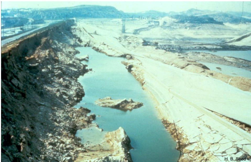
Εικόνα 2.35 : Αστοχία στο ανάκτιο πρανές του φράγματος San Fernando, με άδειο ταμιευτήρα
