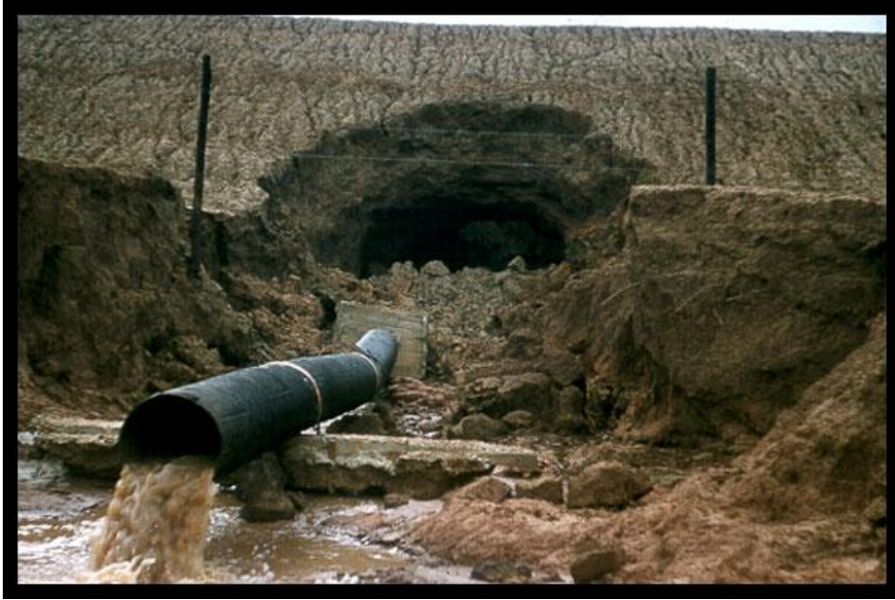
Εικόνα 2.17: Διασωλήνωση λόγω διαρροής σε φράγμα
