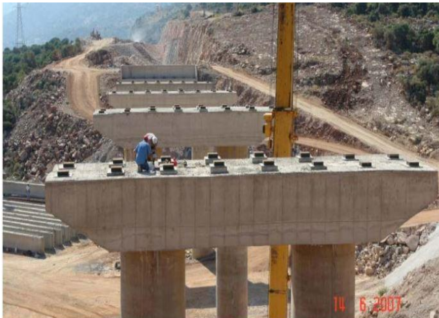
Εικόνα 4.3 Γέφυρα στην Κρήτη στο τμήμα Σταλίδα – Μάλια , τοποθέτηση εφεδράνων στα ακρόβαθρα της γέφυρας
