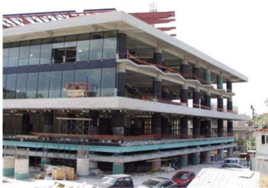
Εικόνα 4.4 μουσείο της Ακρόπολης σε φάση κατασκευής , μεγάλες απαιτήσεις αντισεισμικότητας λόγω της σπουδαιότητας των εκθεμάτων που φιλοξενεί
