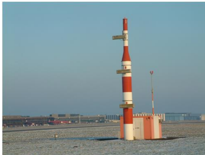
Εικόνα 2.19: Καθοδηγητής τροχιάς κατολίσθησης (GlideSlope) στο αεροδρόμιο του Αννόβερου στη Γερμανία (διάδρομος 09R)
