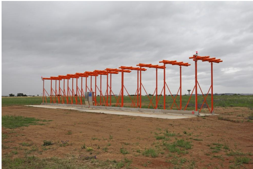
Εικόνα 2.17: Εντοπιστής συστήματος ενόργανης προσγείωσης (Localizer) στο αεροδρόμιο της Μελβούρνης
