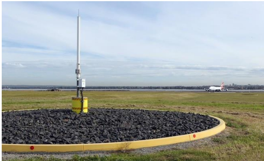
Εικόνα 2.27: Σταθμός μετάδοσης δεδομένων πολύ υψηλής συχνότητας στο αεροδρόμιο του Σύνδεϋ
