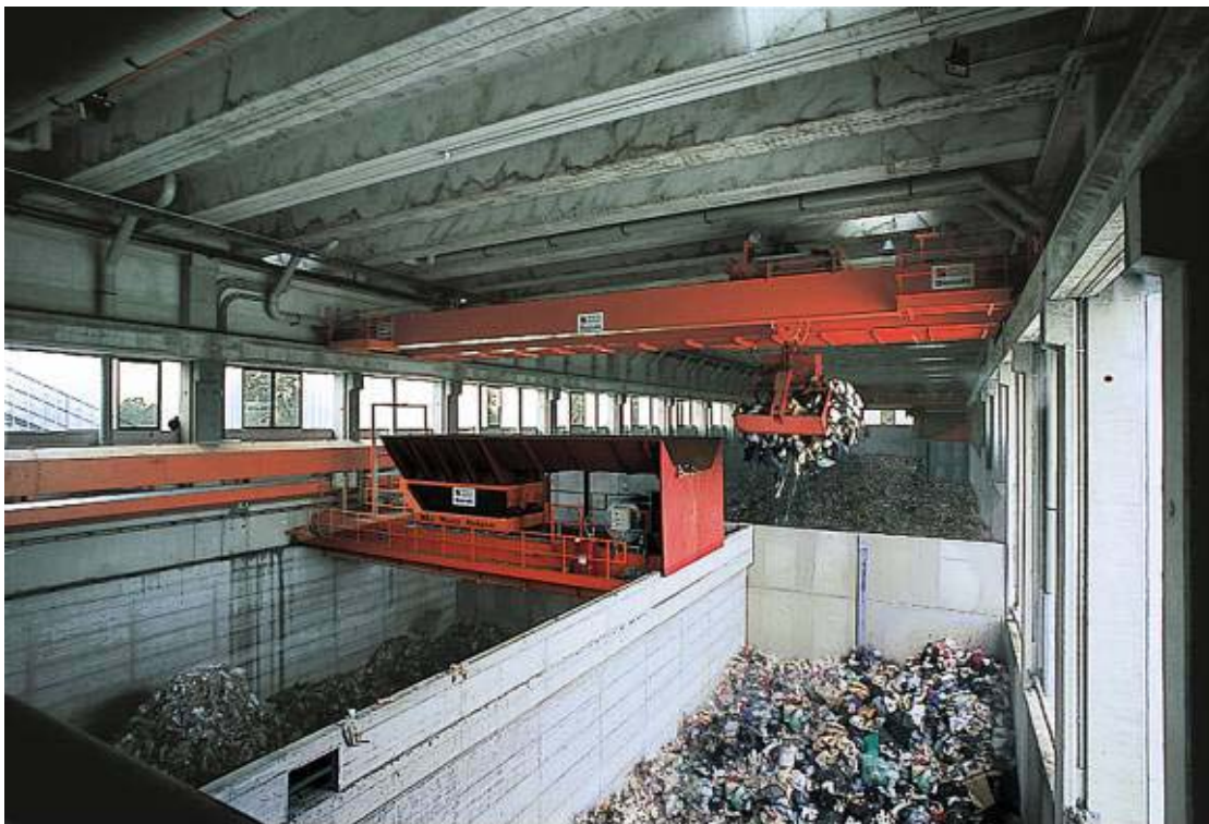
Εικόνα 7.1: Τμήμα Υποδοχής, τεμαχισμού και βιολογικής ξήρανσης απορριμμάτων[2]
