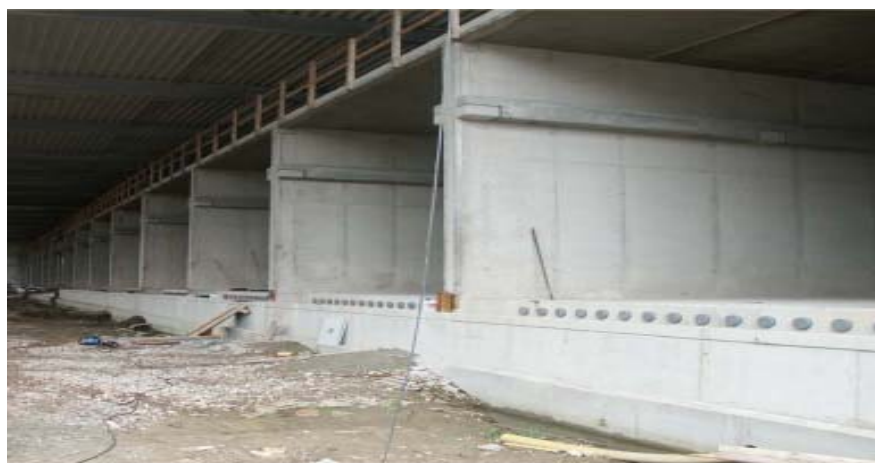
Εικόνα 3.7: Υπό κατασκευή σύστημα κομποστοποίησης σε τούνελ της εταιρίας Horstmann GmbH στο Münster της Γερμανίας
