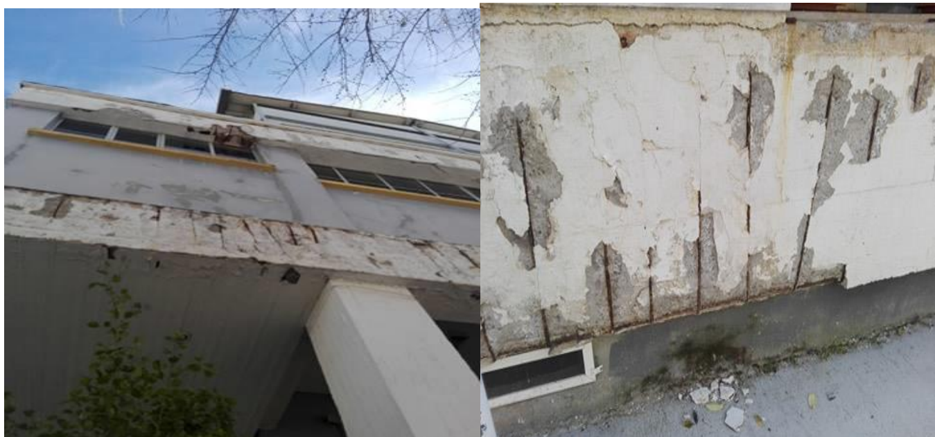
Σχήμα 3.5 Αποφλοιώση σκυροδέματος και εμφάνιση οπλισμών στο εξωτερικό της κατασκευής
