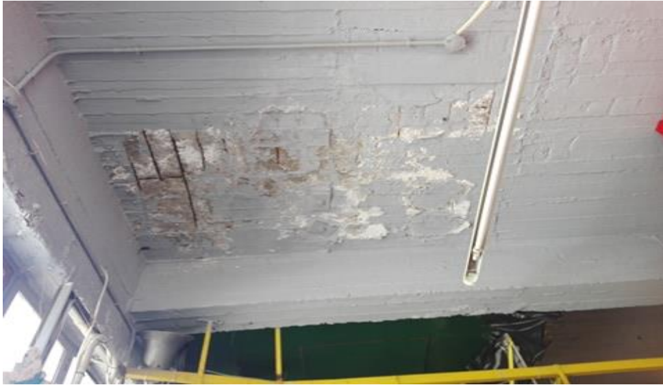
Σχήμα 3.6 Αποφλοίσωση σκυροδέματος στην πλάκα του ορόφου
