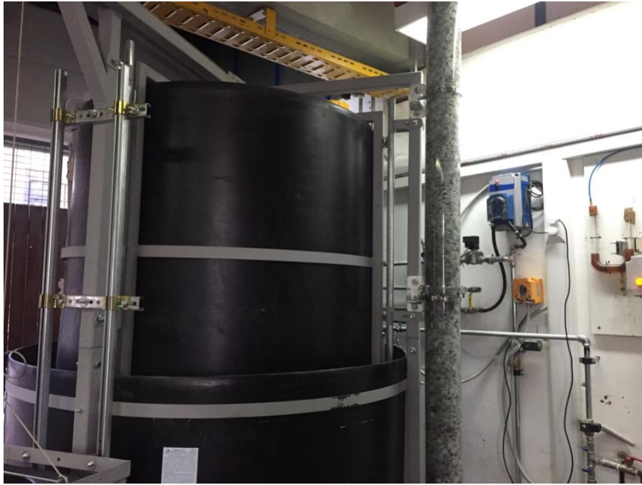
Εικόνα 31 Αεριοφυλάκιο και στήλη χημικής απορρόφησης πιλοτικής εγκατάστασης αναβάθμισης βιοαερίου
