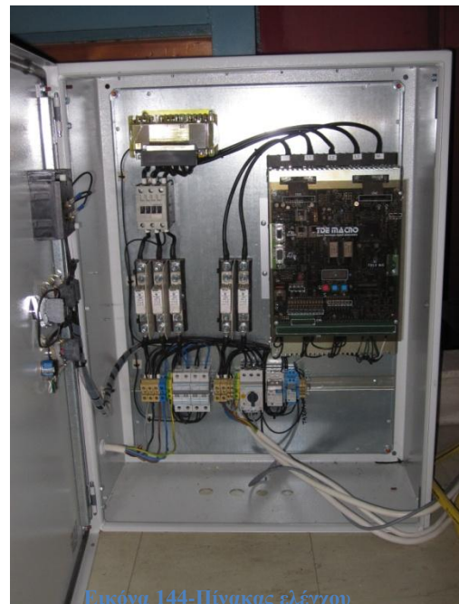
Εικόνα 144-Πίνακας ελέγχου κινητήρα
