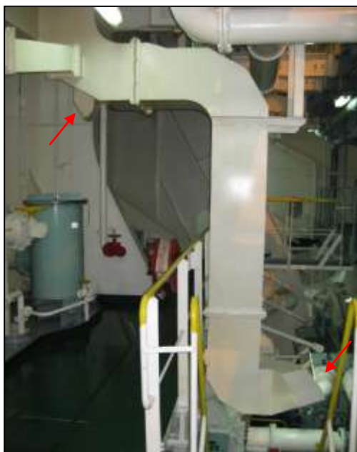
Εικόνα 4.13 Αγωγός εξαερισμού μηχανοστασίου (*)
