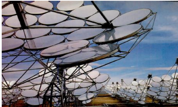
Σχήμα 3.2.7: Οι συλλέκτες (LEC-460) της εγκατάστασης Solar Plant 1 στην Καλιφόρνια της εταιρείας Lajet [3.9].
