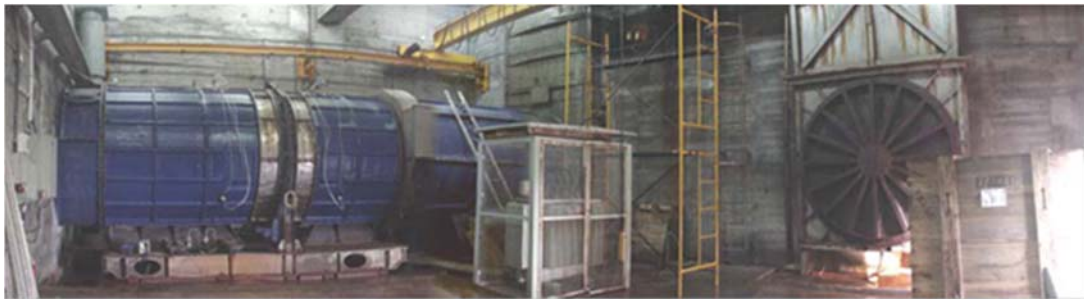
Εικόνα 2.20: Εγκατάσταση στο Pico στις Αζόρες (άνω) και ο αεροστρόβιλος της εγκατάστασης (κάτω) [39]
