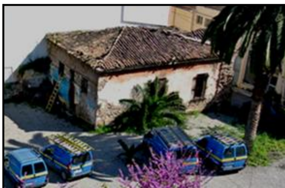
Εικ. 3.2: Το υπό μελέτη κτήριο με τη στέγη πριν καταρρεύσει (φωτογραφία έτος 2013). Διακρίνεται ορθογωνική τετράκλινη στέγη.
