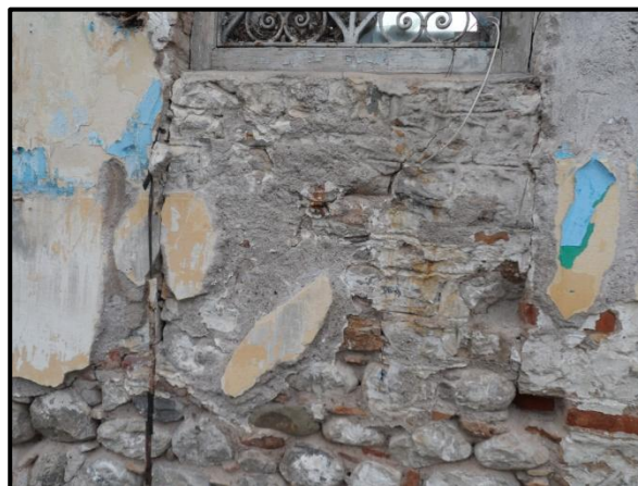
Εικ. 4.5.10: Ρωγμή ΑΟ12
