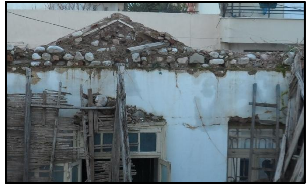
Εικ. 4.9.5: Ρωγμή ΔΟ6 στο σενάζ.
