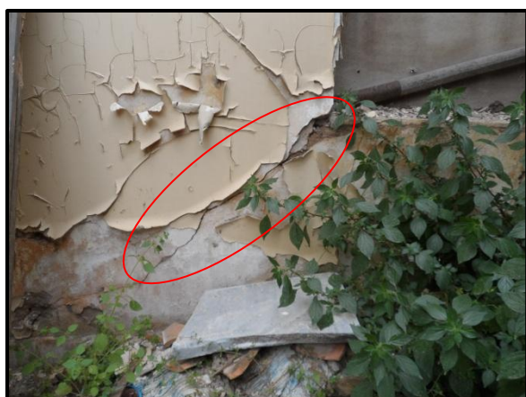
Εικ. 4.9.2: Ρωγμή ΔΟ7
