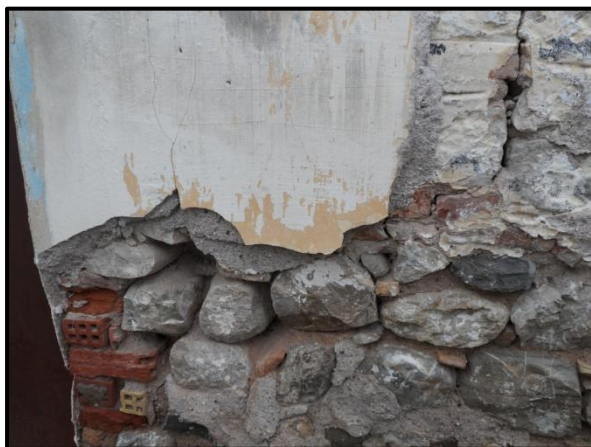
Εικ. 4.5.9: Ρωγμή ΑΟ10
