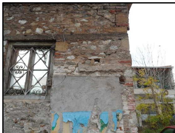
Εικ. 4.5.8: Ρωγμή ΑΟ14
