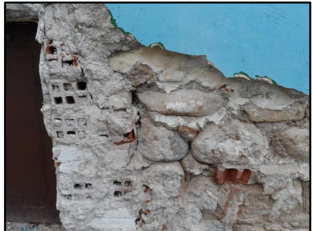
Εικ. 4.5.7: Ρωγμή AO5
