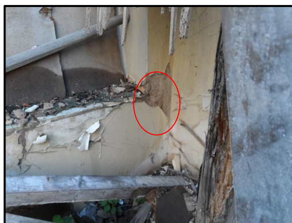
Εικ. 4.9.3: Ρωγμή ΔΟ8
