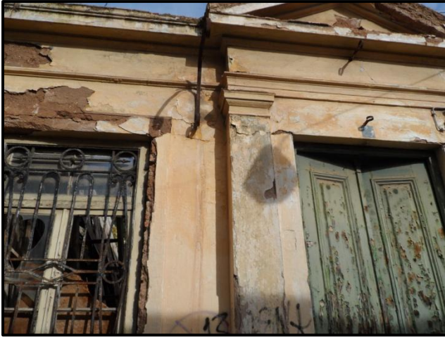
Εικ. 4.4.8: Ρωγμή ΔΟ2 & ΔΟ6
