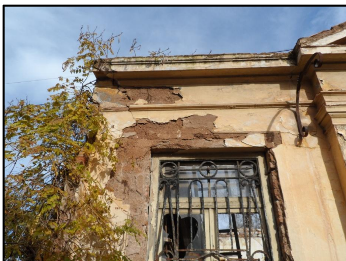
Εικ. 4.4.2: Διακρίνεται η διαγώνια ρωγή ΔΟ1 λόγω διατμητικής επιπόνησης εντός του επιπέδου της τοιχοποιίας και εκτός επιπέδου κάμψης.
