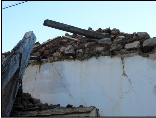
Εικ. 4.9.4: Ρωγμές ΔΟ3, ΔΟ4 & ΔΟ5.
