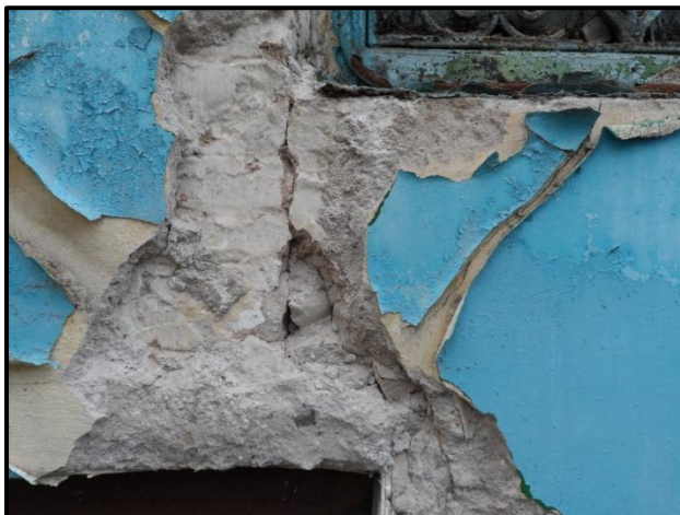
Εικ. 4.5.6: Ρωγμή AO4
