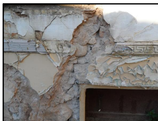
Εικ. 4.8.12: Ρωγμή ΑΟ5
