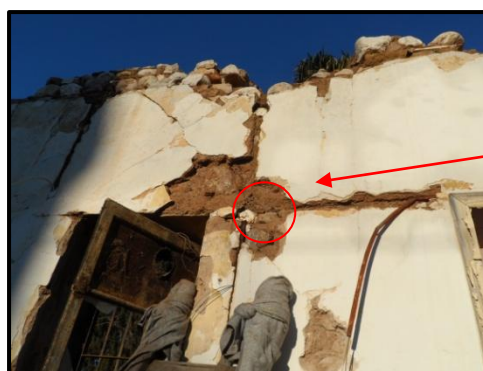
Εικ. 4.8.10: Ρωγμή ΑΟ4
