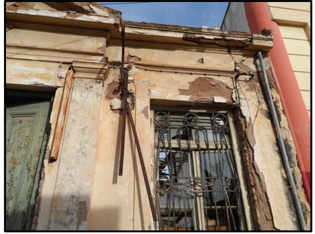
Εικ. 4.4.9: Ρωγμή ΔΟ7
