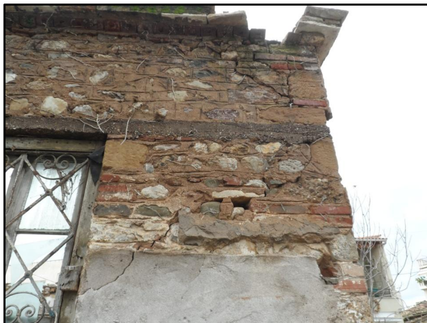
Εικ. 4.5.11: Διακρίνονται οι διαγώνιες ρωγμές της περιοχής 15 λόγω διατμητικής επιπόνησης εντός του επιπέδου της τοιχοποιίας και εκτός επιπέδου κάμψης, αμέσως μετά από την ισχυρή γωνία. Επίσης παρατηρείται αποκόλληση της τοιχοποιίας ελάχιστα προς τα έξω.
