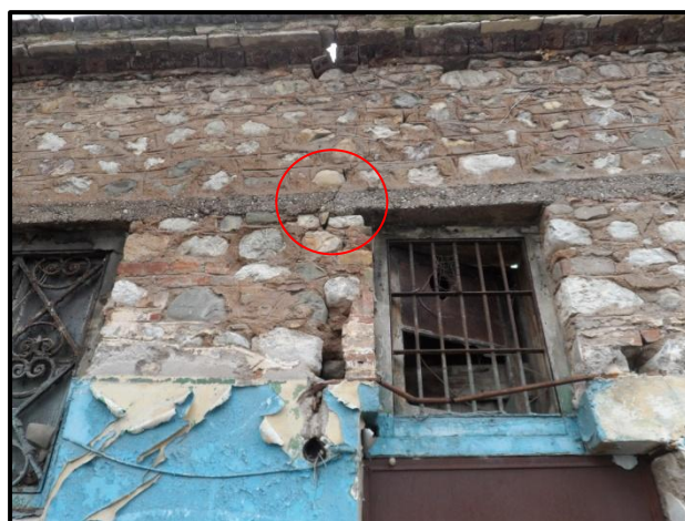
Εικ. 4.5.3: Ρωγμές ΑΟ6 & ΑΟ7
