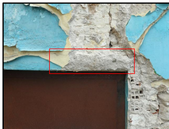
Εικ. 2.14: Μεταγενέστερο σενάζ σκυροδέματος στον λαμπά
