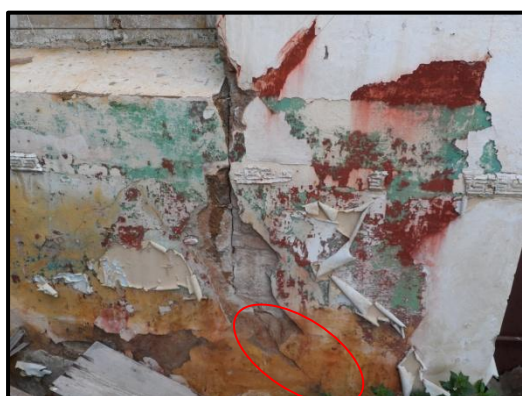
Εικ. 4.8.11: Ρωγμή ΑΟ3
