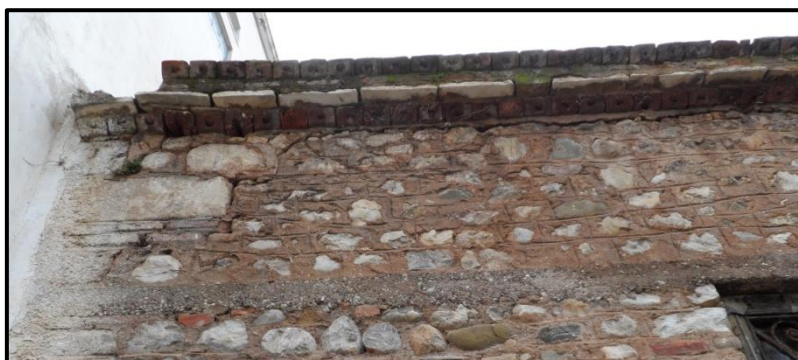
Εικ. 4.10.1: Οριζόντιες ρωγμές κάτω από τη στέψη.
