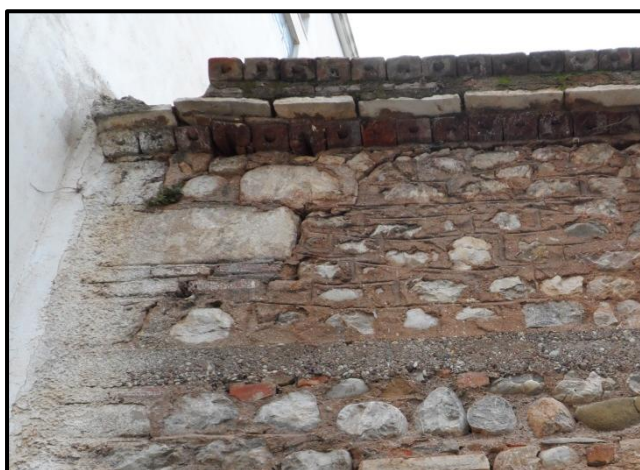
Εικ. 4.5.2: Ρωγμή ΑΟ1
