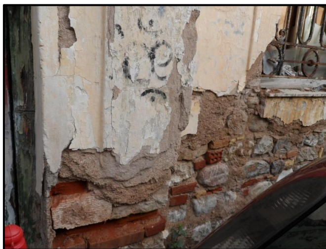
Εικ. 4.10.4: Ρωγμές επιχρίσματος & αποκόλληση επιχρίσματος.
