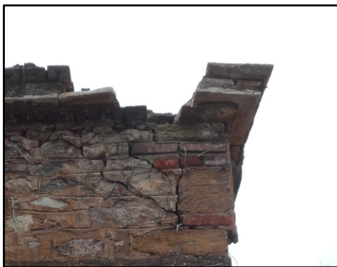
Εικ. 4.13: Αποκόλληση λίθων και οπτόπλινθων από τη στέψη.
