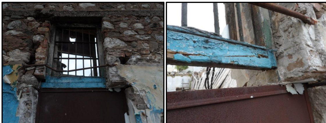
Εικ. 2.15: αριστερά: πριν την αφαίρεση ξύλινου τμήματος του πλαισίου, δεξιά: μετά την αφαίρεση. Η πόρτα & το παράθυρο είναι συνεχόμενο άνοιγμα.
