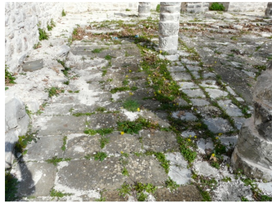
Εικ. 1 Καθίζηση του εσωτερικού δαπέδου
