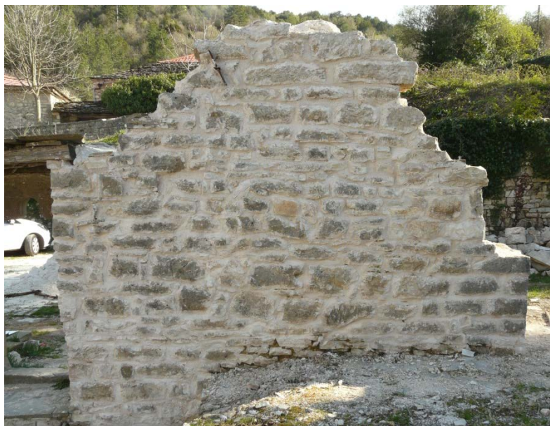
Εικ. 16 Υπολείμματα ελκυστήρα νότιας τοιχοποιίας
