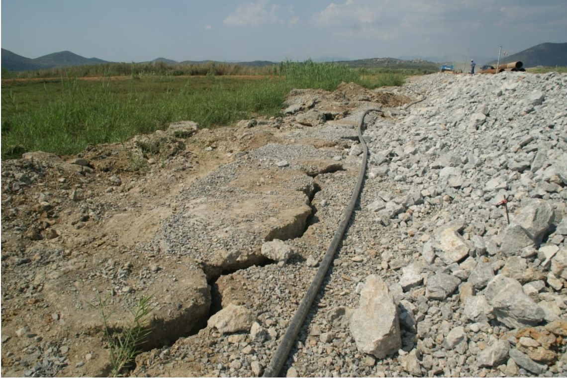
Εικόνα Β-3: Οι πάσσαλοι άοπλου σκυροδέματος στον πόδα του επιχώματος διακρίνονται λόγω της καθίζησης του επιχώματος.
