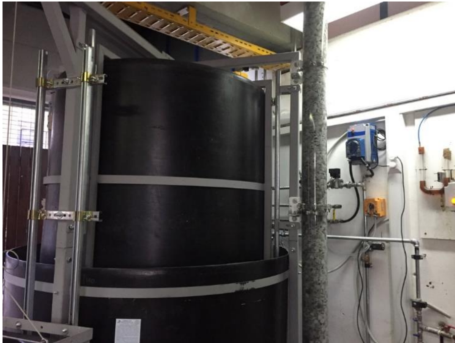
Εικόνα 23. Αεριοφυλάκιο και στήλη χημικής απορρόφησης πιλοτικής εγκατάστασης αναβάθμισης βιοαερίου .
