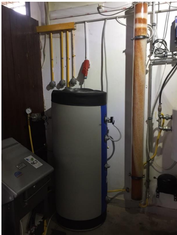
Εικόνα 24. Σύστημα Συμπιεστή- Buffer- και απομάκρυνσης υγρασίας
