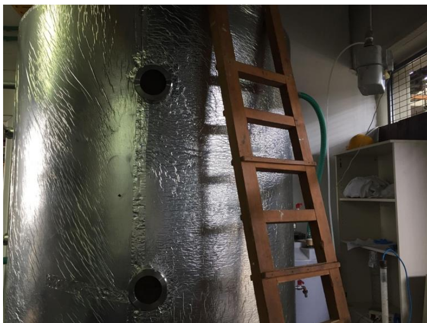
Εικόνα 16. Αναερόβιος χωνευτήρας 4m 3 για την αναερόβια χώνευση του FORBI
