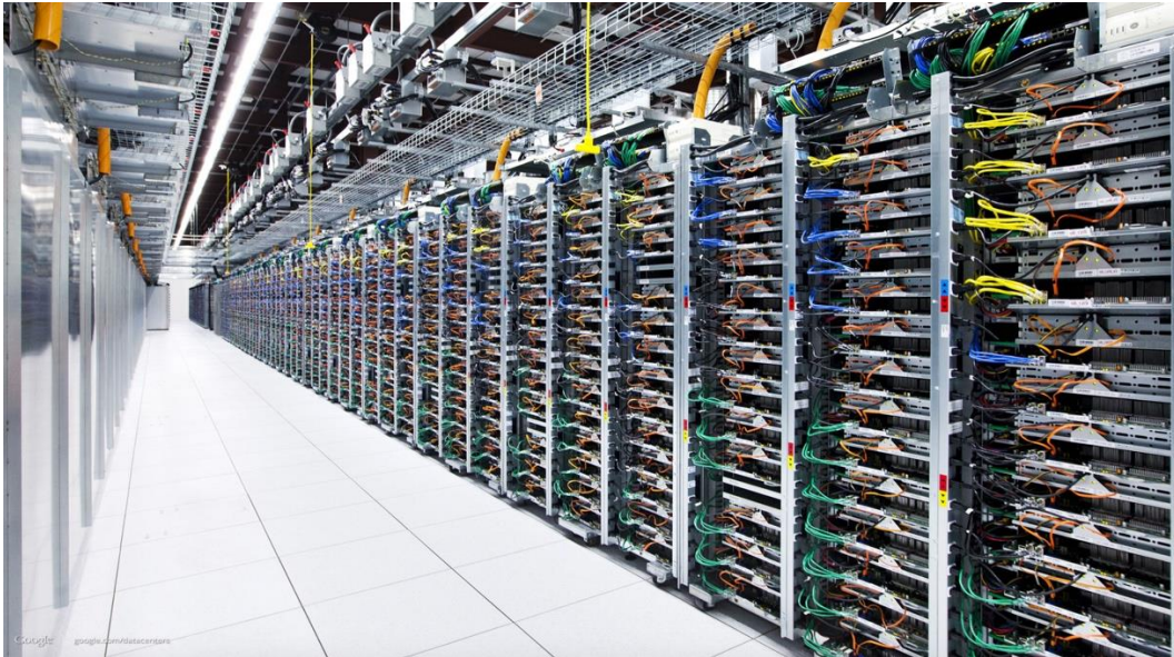
Εικόνα 2.3.: Κέντρο δεδομένων της Google στην Οκλαχόμα, Πηγή: Περιοδικό Fortune
