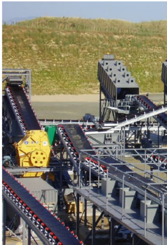
Σχήμα 3.6 - Θραυστήρας (με κίτρινο χρώμα) και μεταφορικές ταινίες
