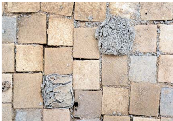
Εικόνα 23. Φθορά από κρυστάλλωση αλάτων στο πορώδες των ψηφίδων.
