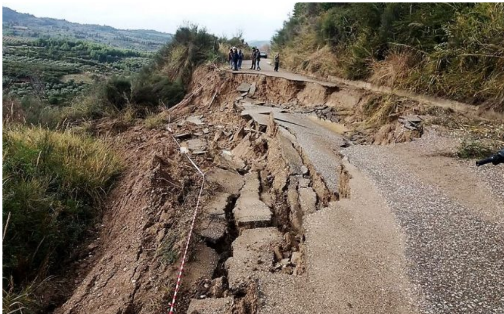
Εικόνα 3.12: Καθίζηση οδοστρώματος σε ορεινή θέση του Ν. Ηλείας.
