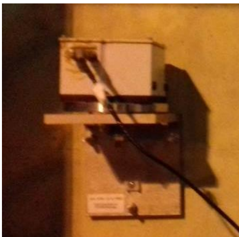
Σχήμα 4. 5 : Εγκαταστημένο κλισίμετρο στη στέψη του πυλώνα M8.
