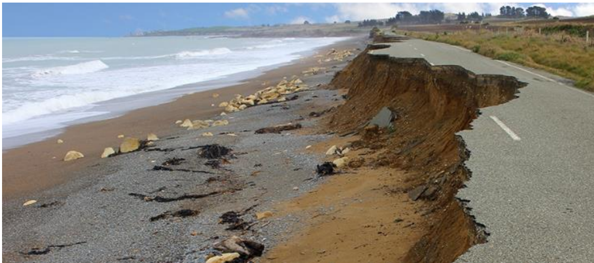
Εικόνα 3.1 Διάβρωση παραλιακού μετώπου από προσπίπτοντες κυματισμούς (Dhigroup.com)
