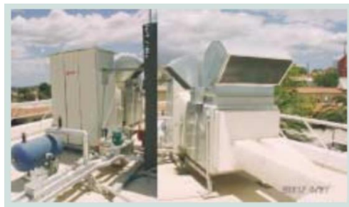
Εικόνα 3.8 : Ηλιοβοηθούμενη αντλία θερμότητας αέρα - νερού για την θέρμανση και την ψύξη του ορόφου [34]
