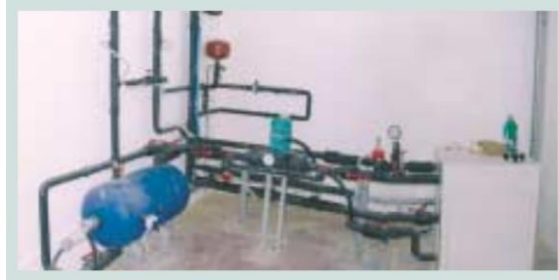
Εικόνα 3.7 : Γεωθερμική Αντλία θερμότητας νερού - νερού για θέρμανση και ψύξη του ισογείου [34]
