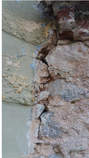
3. 12: Αποκόλληση τμήματος της ένωση καμπύλου τμήματος με επίπεδο κοντά στην στέγη
