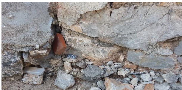
2. 27 Γωνία σύνδεσης νότιας και δυτικής όψης. Κακώς λαξευμένοι λίθοι μικρών διαστάσεων
