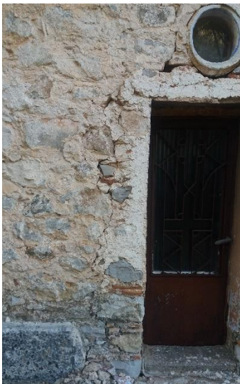
3. 10 Διαμπερής ρωγμή λόγω πρόχειρης διάνοιξης
