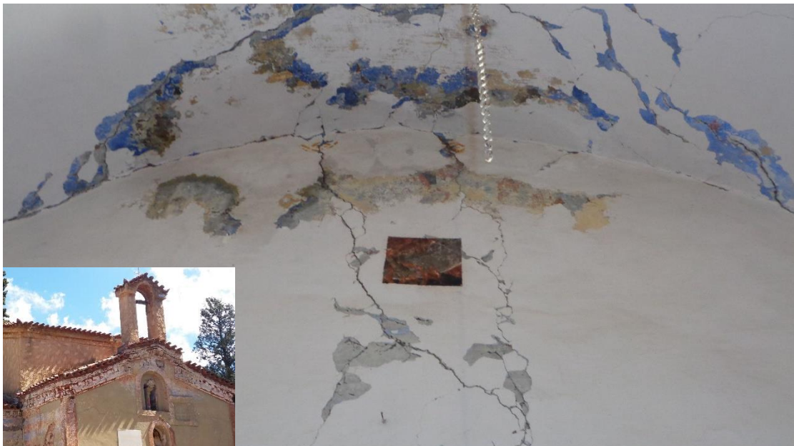
3. 9 Η επίδραση της υγρασίας στην οροφή που αντιστοιχεί εξωτερικά με την θέση του κωδωνοστασίου
