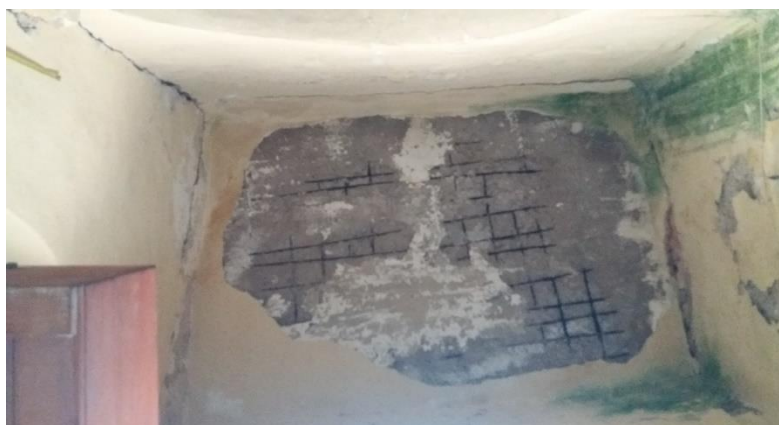
3. 5 Αποφλοιωμένη επιφάνεια επιχρίσματος και διαβρωμένος ο οπλισμός της οροφής του νότιου παραβήματος
