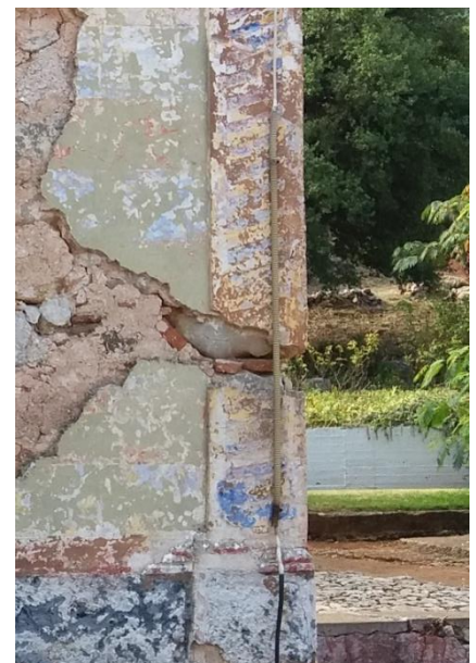
2. 28 Περιοχή σύνδεσης της βόρειας και δυτικής όψης. Αποκάλυψη μη λαξευμένου λίθου στην περιοχή της ρωγμής Δ1
