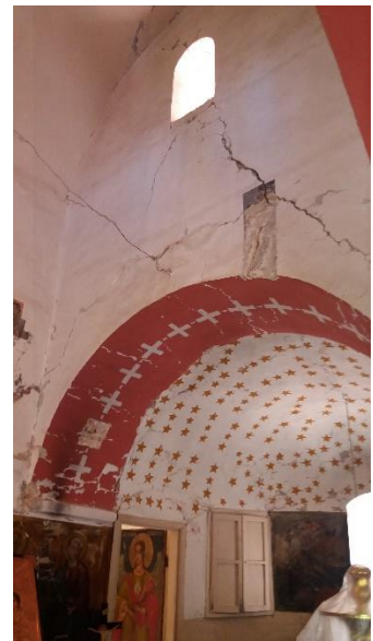
3. 20: Διατμητικές αστοχίες στο τύμπανο της νότιας όψης
