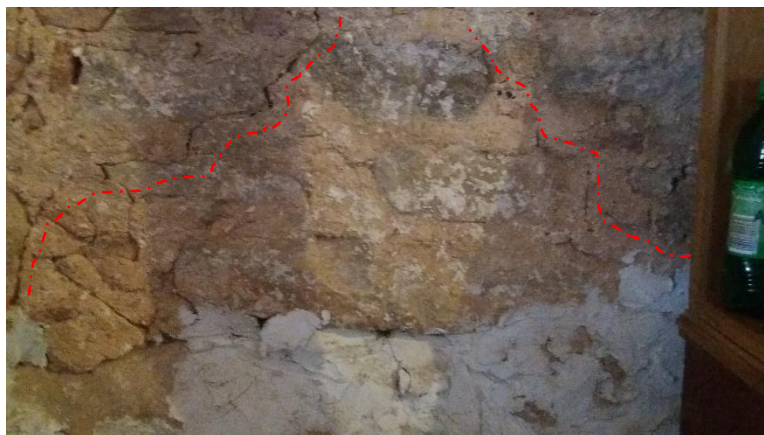
3. 22: Διατμητική ρωγμή στην βόρεια όψη του νάρθηκα
