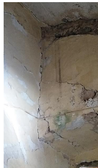
3. 30 Αποφλοίωση εξωτερικών στρώσεων επιχρίσματος στον εσωτερικό χώρο του ναού
