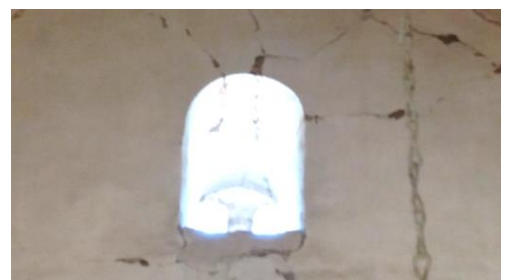
3. 17 Λοξές ρωγμές στο υπέρθυρο της βόρειας όψη, κοντά στον άνοιγμα του βόρειου τυμπάνου
