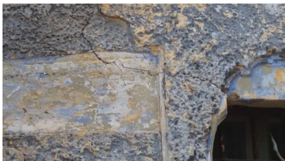
3. 16 Λοξή ρωγμή στο υπέρθυρο της βόρειας κόγχης
