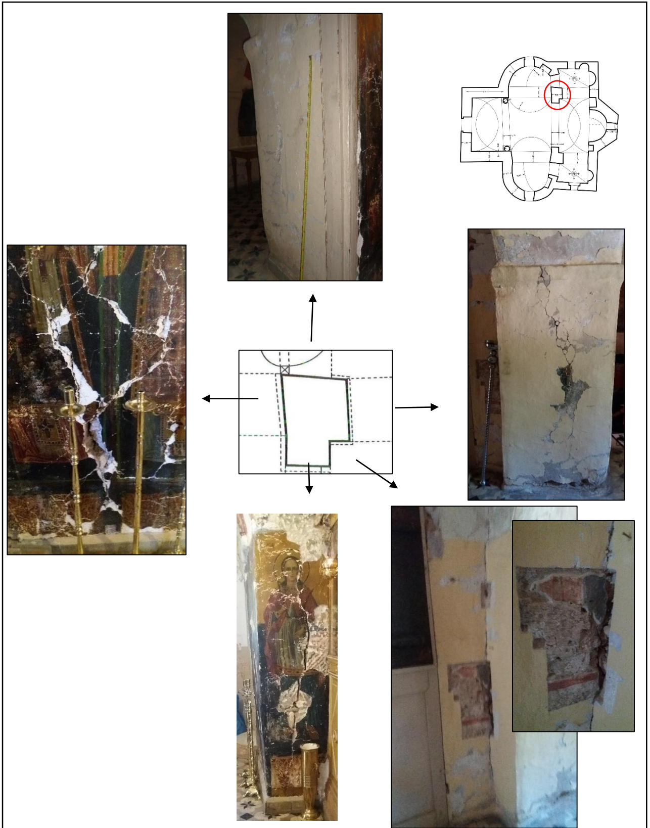
3. 23 Κατακόρυφες ρωγμές και στις τέσσερις όψεις του νότιου πεσσού
