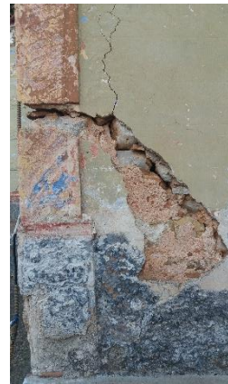
3. 15: Λοξή ρωγμή στην Δυτική όψη μεγάλου εύρους και βάθους (ενδεχομένως είναι χτισμένο πάνω σε λείψανα παλαιότερου τμήματος ναού)
