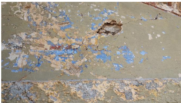
3. 14. Λοξή ρωγμή στην Ανατολική όψη κοντά στον αρμό των δύο κατασκευαστικών φάσεων
