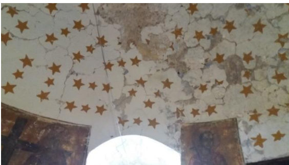
3. 3 Διάβρωση της οροφής στην βόρεια κόγχη
