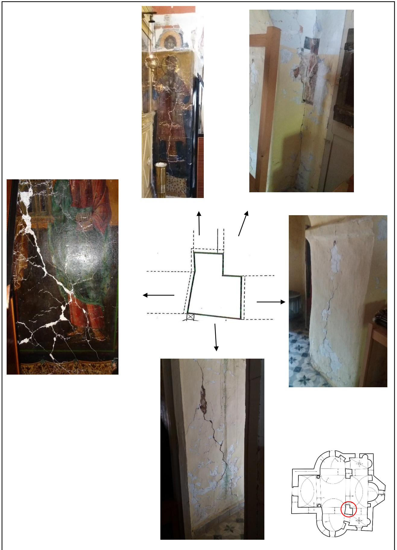
3. 24 Κατακόρυφες ρωγμές και στις τέσσερις όψεις του νότιου πεσσού
