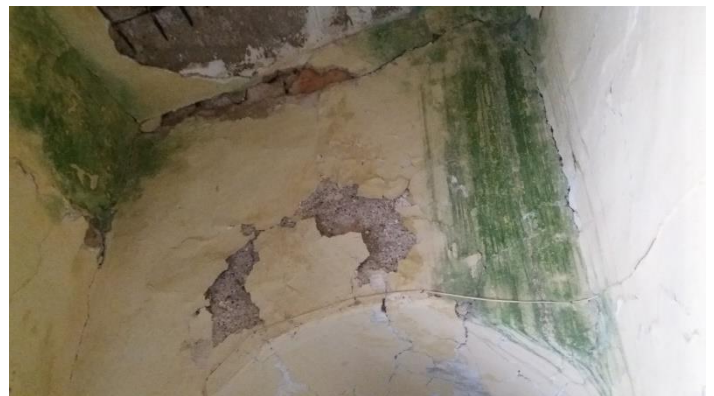
3. 4 Υγρασία-μούχλα στην αποφλοιωμένη πλέον επιφάνεια στο χώρο του νότιου παραβήματος
