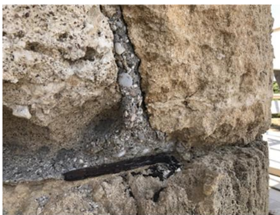
Εικόνα 15. Διαβρωμένος μεταλλικός σύνδεσμός
