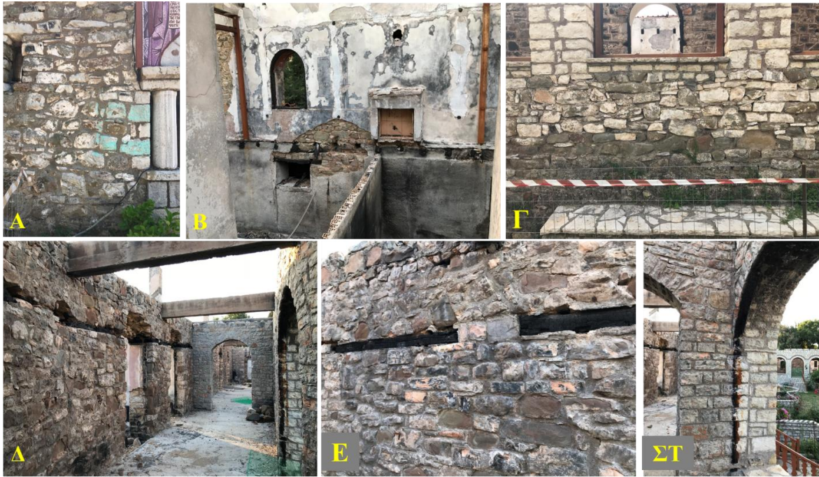
Εικόνα 2.3.: Διαφορετικές περιοχές των κελιών : (α) το εξωτερικό του εξωτερικού τοίχου (ιστορική τοιχοποιία), (β) η επιχρισμένη εσωτερική πρόσοψη του εξωτερικού τοίχου που παρουσιάζει σοβαρές επιπτώσεις από την πυρκαγιά (ιστορική τοιχοποιία), (γ) (νέα τοιχοποιία), (δ) ιστορική ενδιάμεση τοιχοποιία, (ε) λεπτομέρεια από την ενδιάμεση τοιχοποιία και (στ) η νέα τοιχοποιία των κελιών, : η εξωτερική πρόσοψή του φαίνεται ανέπαφη μετά από τη φωτιά, ενώ το εσωτερικό του έχει υποστεί ζημιές από πυρκαγιά.[59]
