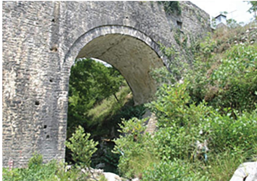
Εικόνα 14: Ρηγμάτωση ανατολικού ανακουφιστικού τόξου
