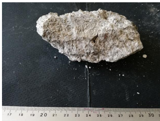
Εικόνα 30: PL.HM_3 : Εσωτερικό κονίαμα σύνδεσης λίθων από εναπομείναν τμήμα 1
