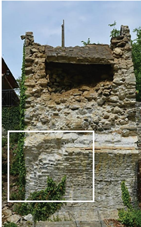
Εικόνα 21: Επιφάνεια αστοχίας ανατολικού βάθρου και ύπαρξη ξύλινου στοιχείου
