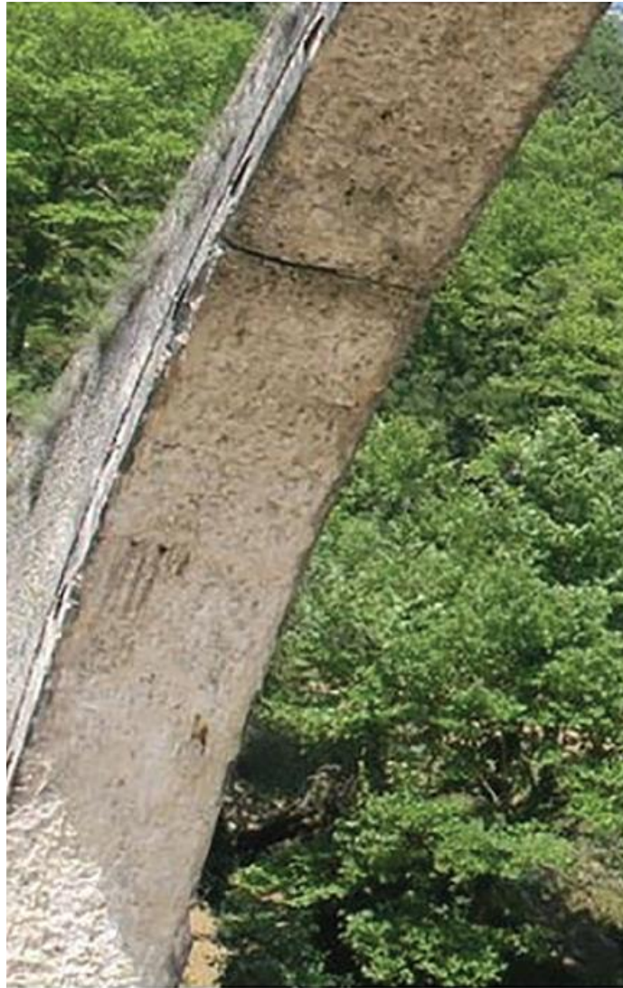
Εικόνα 11: Βλάβη στο εσωράχιο του κυρίως τόξου
