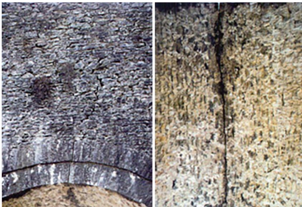
Εικόνα 12: Βλάβη στο ανακουφιστικό τόξο του δυτικού βάρου
