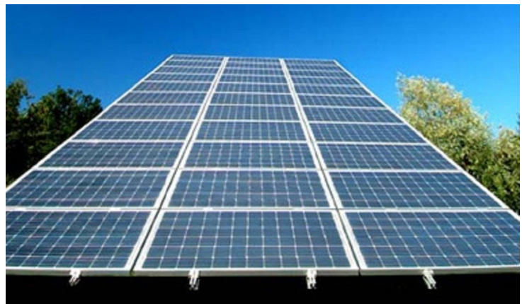
Εικ.9.4. Φωτοβολταϊκή συστοιχία[46]
