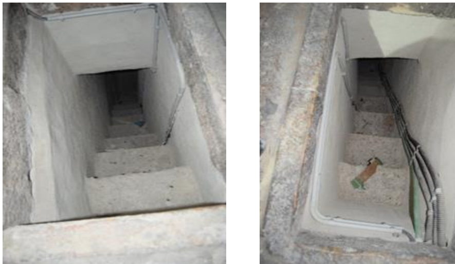
Εικόνα 4.10: Οδεύσεις καλωδίων από τα κλιμακοστάσια του Ιερού Κουβουκλίου
