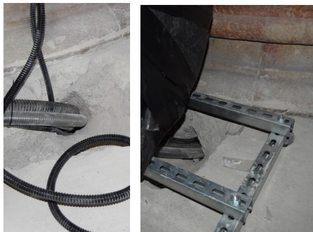
Εικόνα 1.14: Όδευση σωληνώσεων από το δώμα προς το εσωτερικό του Ιερού Κουβουκλίου
