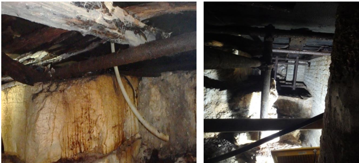
Εικόνα 3.7: Έντονη διάβρωση στους υπόγειους χώρους
