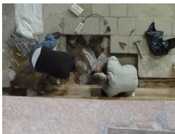
Εικόνα 4.16: Εντοιχισμένος ενσύρματος αισθητήρας DMS9 στη βάση της νότιας τοιχοποιίας
