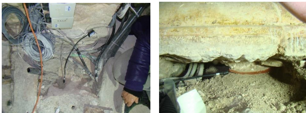
Εικόνα 4.15 : Εντοιχισμένος ενσύρματος αισθητήρας DMS8 στο δάπεδο του δώματος
