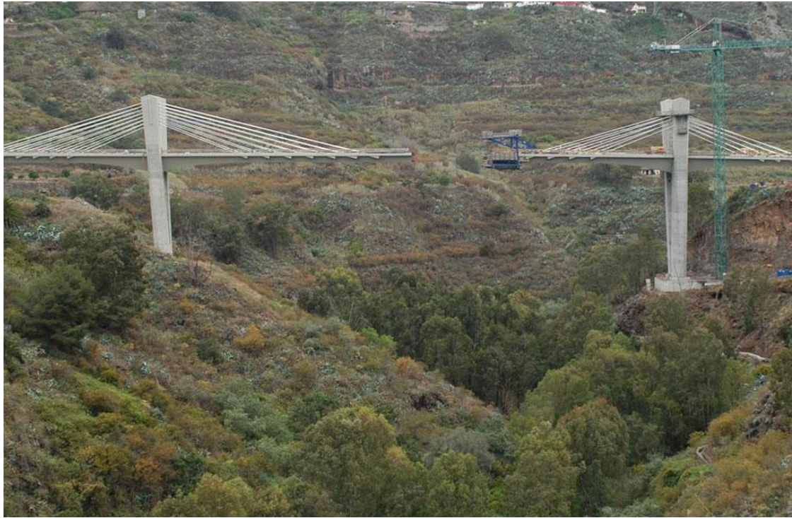
Εικόνα 35 Πριν την αποκατάσταση της συνέχειας (1)
