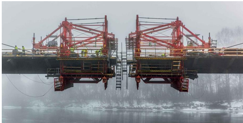
Εικόνα 18 Πρόβολοι πριν την αποκατάσταση συνέχειας
