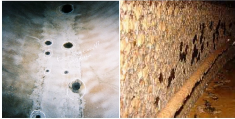
Εικόνα 1-2: Βιοδιάβρωση (MIC) σε πυθμένα δεξαμενής λόγω βακτηρίων τύπου SRB.
