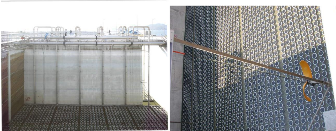
Σχήμα 2.3.2.1 Σύστημα διάχυτου αερισμού στην Εγκατάσταση Επεξεργασίας Λυμάτων της Ψυτάλειας (πηγή: Σημειώσεις μαθήματος “Εγκαταστάσεις Επεξεργασίας & Διάθεσης Αστικών Απόβλητων” 9 ου εξαμήνου της Σχολής Πολιτικών Μηχανικών)
