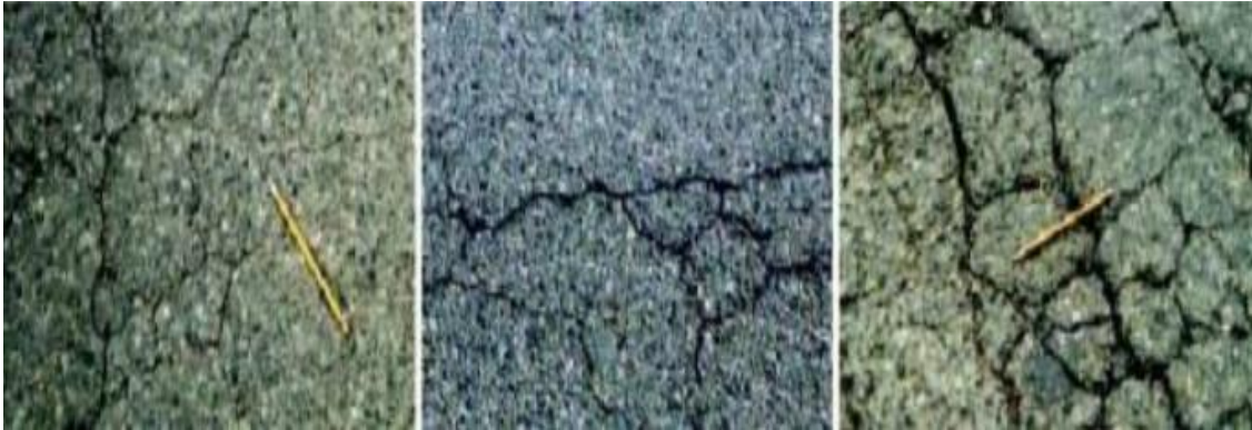
Εικόνα 2.4: Ρωγμές τύπου αλιγάτορα
