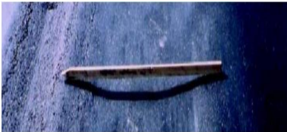
Εικόνα 3.6: Παραμόρφωση επιφάνειας κύλισης οδοστρώματος
