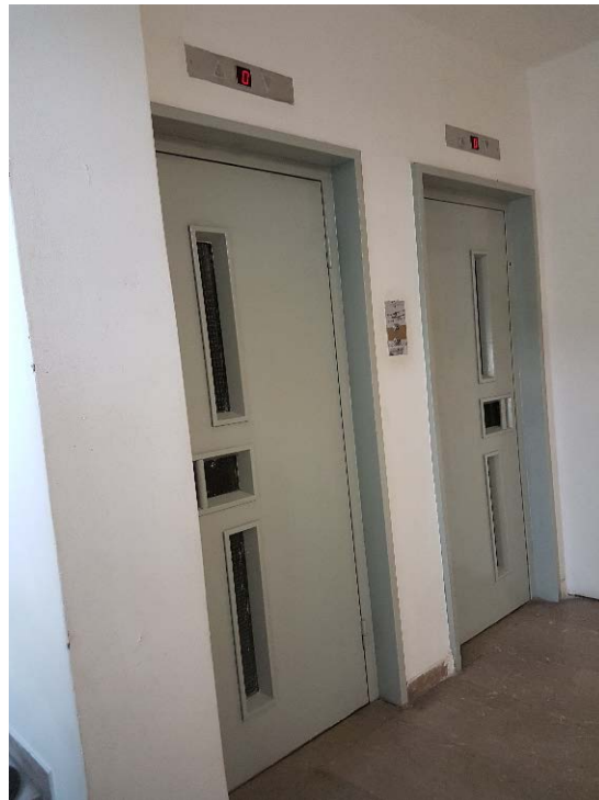
Εικόνα 4.16: Ανεγκυστήρες 2ου ορόφου
