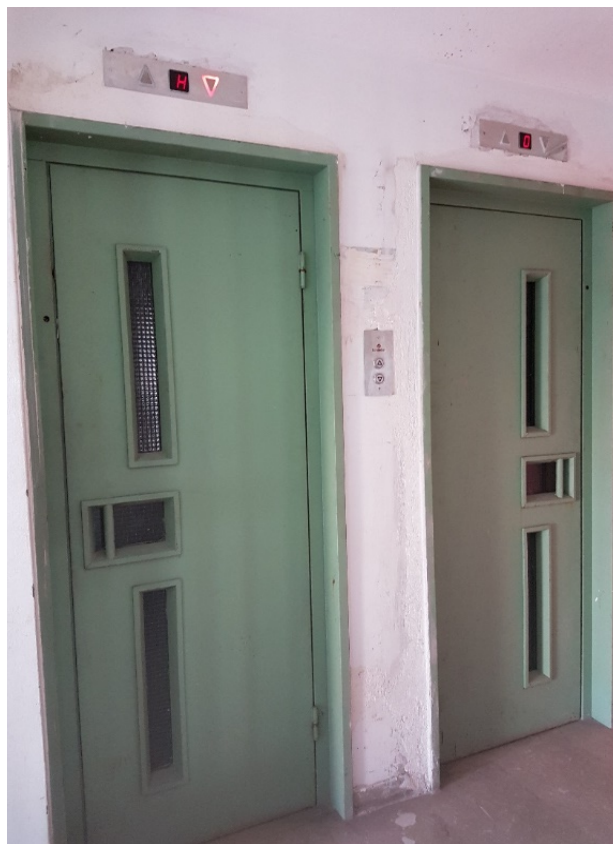
Εικόνα 4.13: Ανεγκυστήρας 2ου ορόφου
