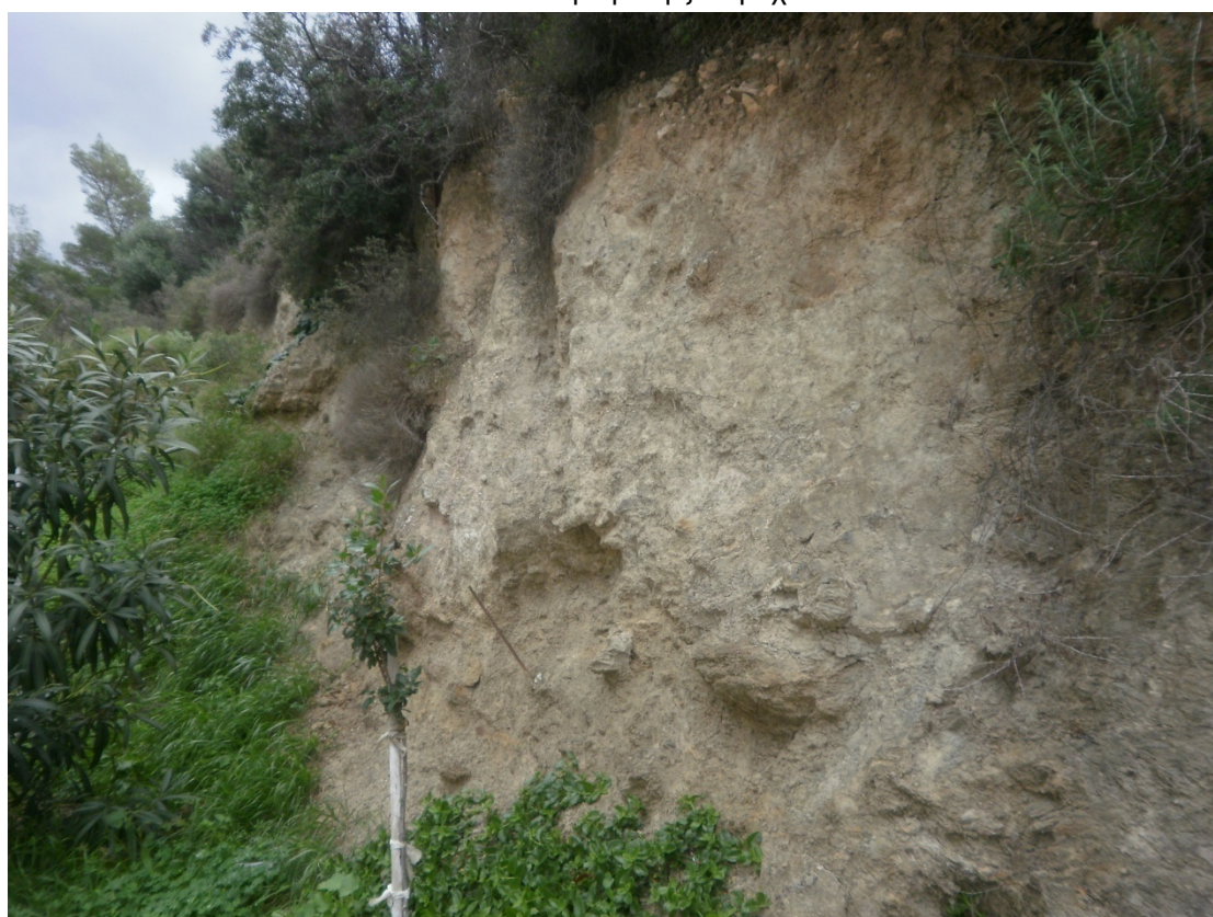
Εικόνα 5.49 Πρανές πλήρως κατακερματισμένου σχιστολίθου στην περιοχή Πηγαδάκια.
