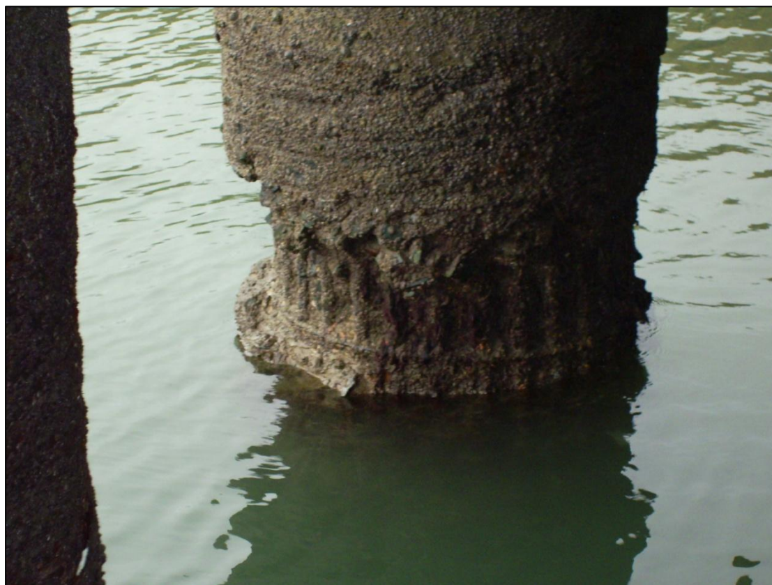
Εικόνα 12. Διάβρωση πασσάλων κρηπιδότοιχου από τη δράση της προπέλας.
