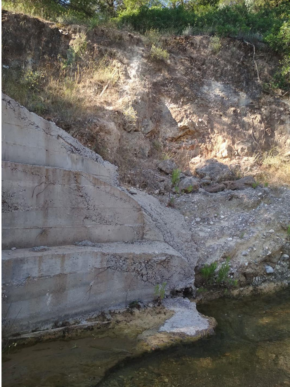
Εικόνα 3-26: Υποσκαφή των βάθρων της γέφυρας Αγ. Δημητρίου.
