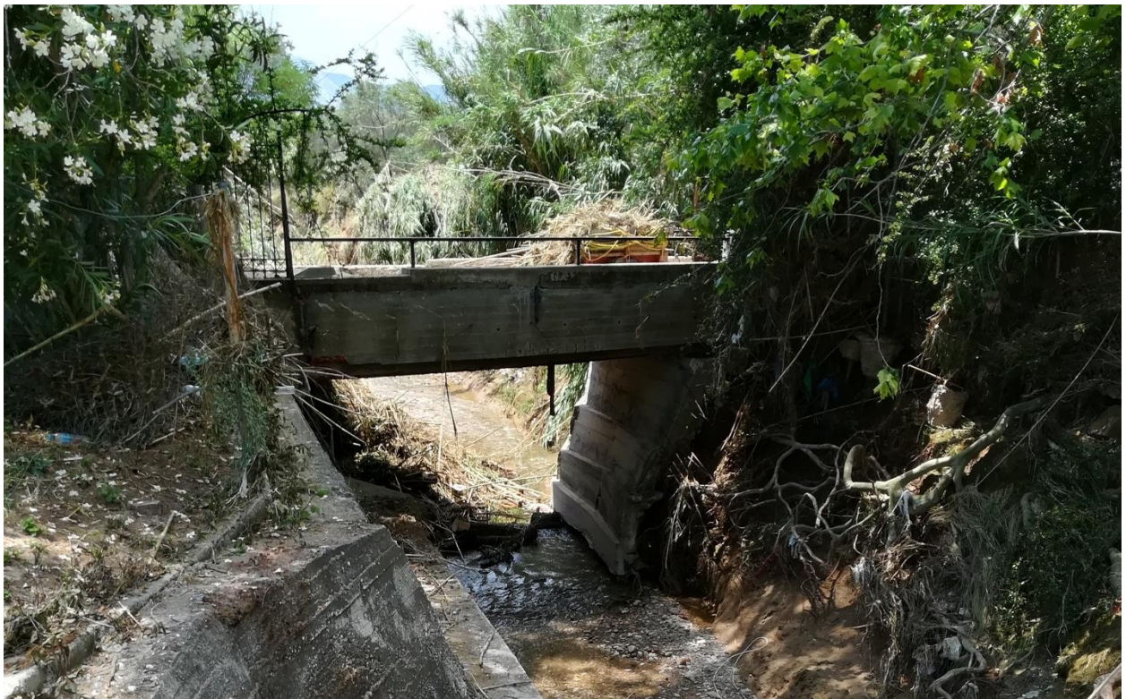
Εικόνα 3-49: Άποψη της γέφυρας στη Θ7. Φαίνεται η υποσκαφής της.
