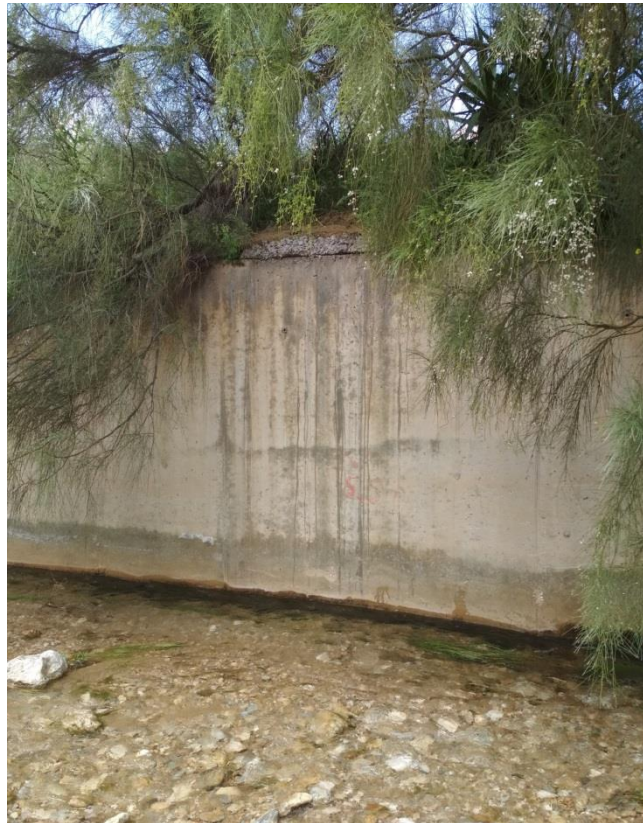
Εικόνα 3-23: Τοίχος αντιστήριξης στη Θ2. Στη βάση του τοίχου αντιστήριξης εμφανίζεται το βραχώδες υπόβαθρο λόγω της υποσκαφής του.
