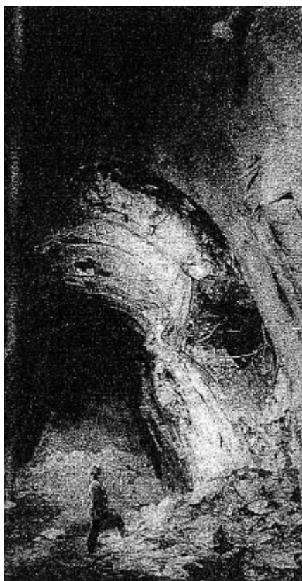
Εικόνα 2.6 - Παραμορφωμένη υποστήριξη λόγω διογκούμενων αργίλων, Νάπολη, Ιταλία (Wallis, 1991).
