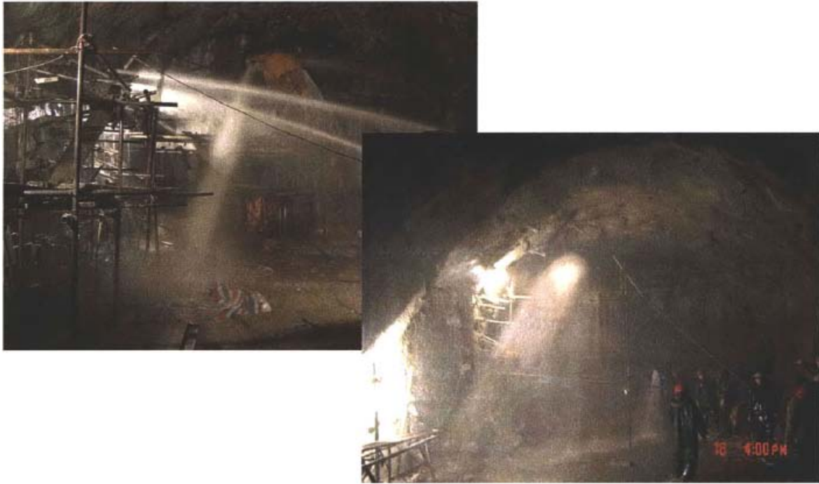
Εικόνα 2.4 - Εισροή νερού υπό πίεση σε σήραγγα, Κίνα. (Sousa et al., 2010).
