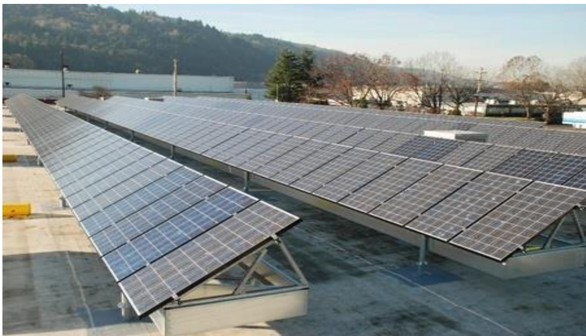
Εικόνα 3.5: Ηλιακά πάνελ σε ξενοδοχείο στα Ιωάννινα (Πηγή: selasenergy, 2012)
