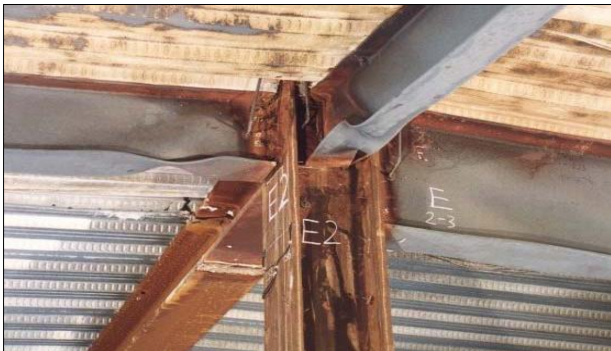
Εικ. 2.13 Ο τοπικός λυγισμός των μελών απέτρεψε την αστοχία στον κόμβο [Scott D. et al.].
