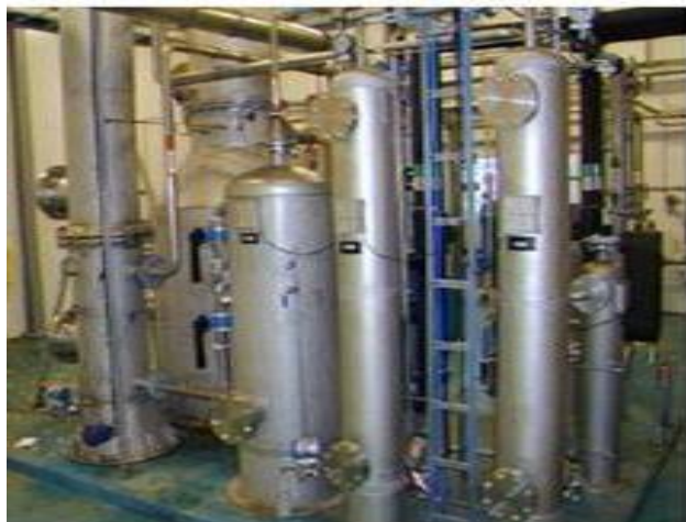
Σχήμα 10. Σύστημα αναβάθμισης βιοαερίου με έκπλυση με νερό
