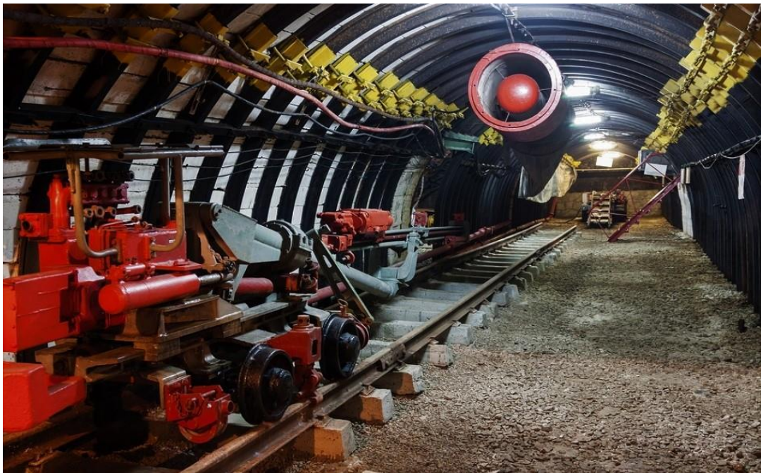
Εικόνα 3.14 : Αποψη ανεμιστήρα βοηθητικού αερισμού
