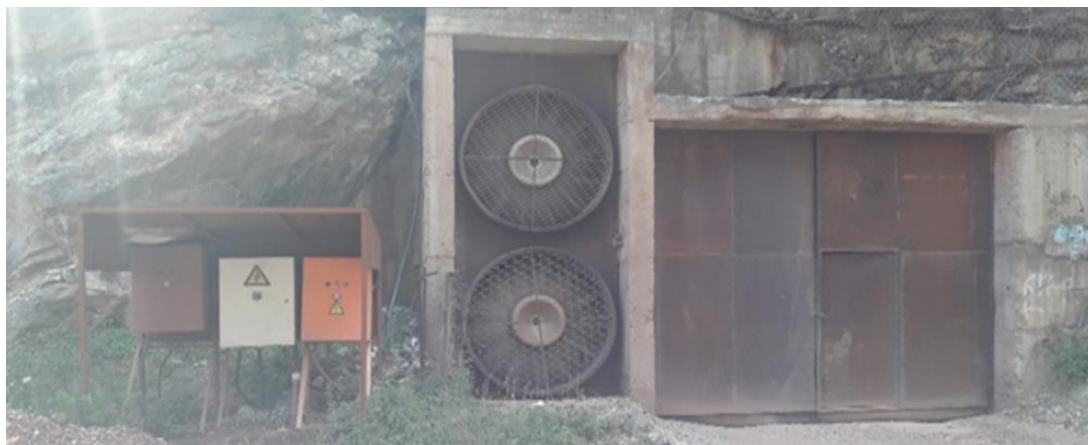
Εικόνα 5.3 Κεντρικοί ανεμιστήρες φυσητικού τύπου, σε παράλληλη σύνδεση στο στόμιο της στοάς Σ617
