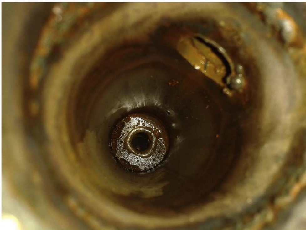
Εικ. 13. Διάβρωση ενός αγωγού πλούσιου διαλύματος αμίνης.
