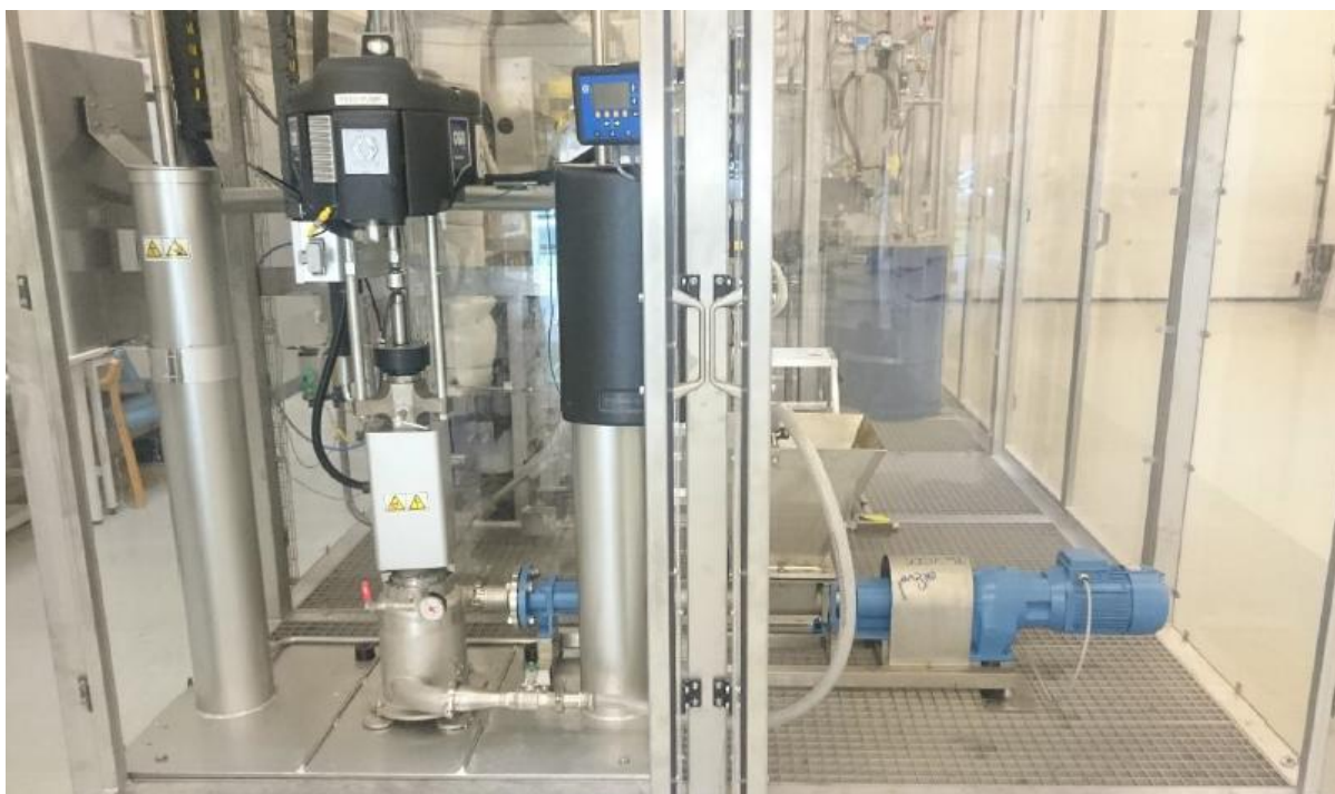
Εικ.8 Δεξαμενή Τροφοδοσίας με Σύστημα Ανακυκλοφορίας και Αντλία Τροφοδοσίας
