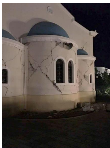
Εικόνα 1.7 Διατμητική αστοχία λόγω σεισμού σε ναό στην Κω
