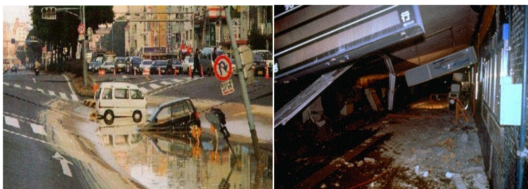
Εικόνα 7.2: Καθίζηση οδοστρώματος λόγω κατάρρευσης της οροφής του σταθμού Dakai, Kobe, Ιαπωνία, Π. Ματσούκας, Β. Φλεντζούρης, 2007.
