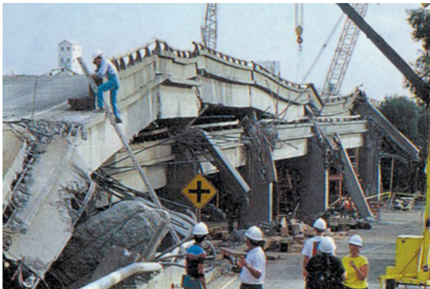
Εικόνα 2.3: Καταστροφές που σημειώθηκαν στον αυτοκινητόδρομο (Interstate 880 - Nimitz Freeway), http://littleshell.earthsourcemedia.org/category/uncategorized/
