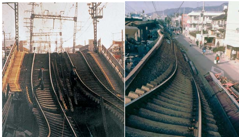
Εικόνα 2.6: Βλάβες στο σιδηροδρομικό δίκτυο Hanshin-Kobe, Ιαπωνία, σεισμός 1995. Το σιδηροδρομικό δίκτυο έμεινε εκτός λειτουργίας για περίπου 6 μήνες, http://www.diktyoseismos.gr/about-earthquakes/earthquakes-consequences.php
