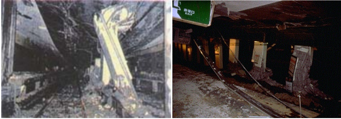
Εικόνα 7.3: Αστοχία κεντρικής συστοιχίας υποστυλωμάτων που οδήγησε στην κατάρρευση της πλάκας της οροφής του σταθμού Dakai, Kobe, Ιαπωνία, Π. Ματσούκας, Β. Φλεντζούρης, 2007.
