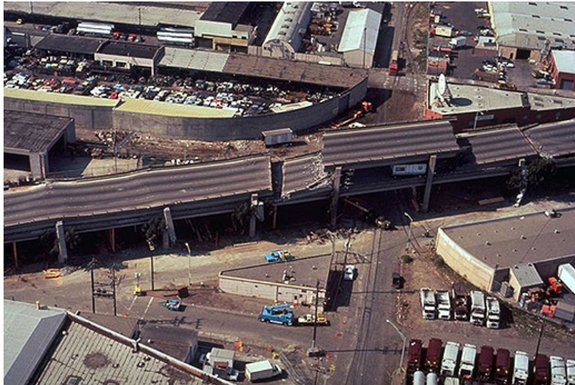
Εικόνα 2.4: Καταστροφές στον αυτοκινητόδρομο Interstate 880 - Nimitz Freeway, http://www.vibrationdata.com/earthquakes/lomaprieta.htm
