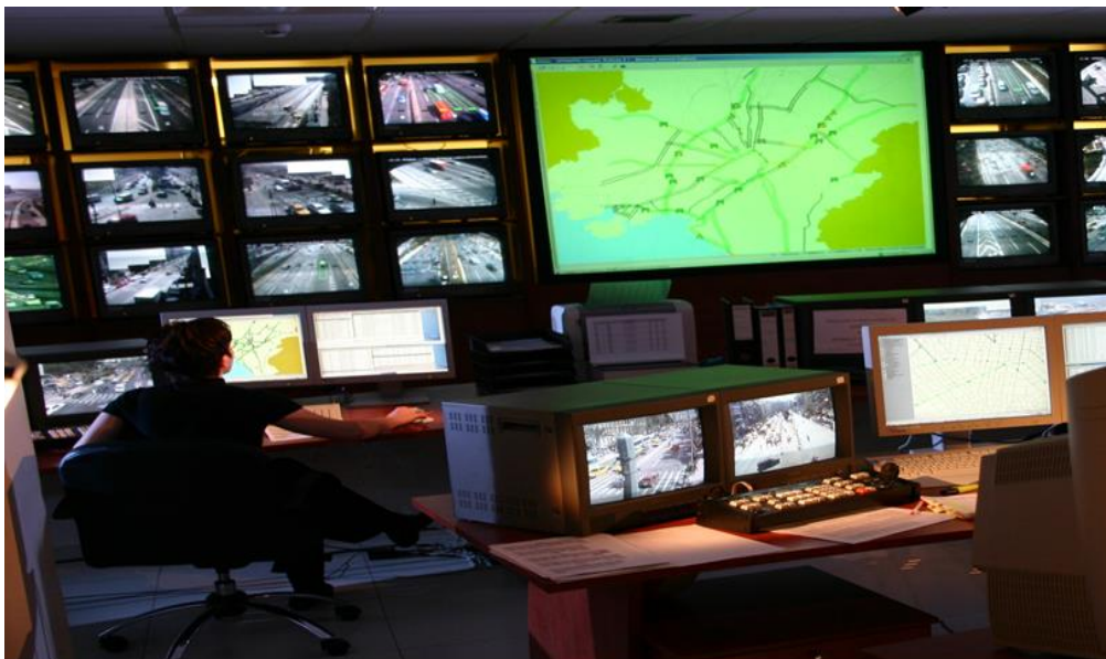
Εικόνα 3-12: Κέντρο Διαχείρισης Κυκλοφορίας (Κ.Α.Κ.)
