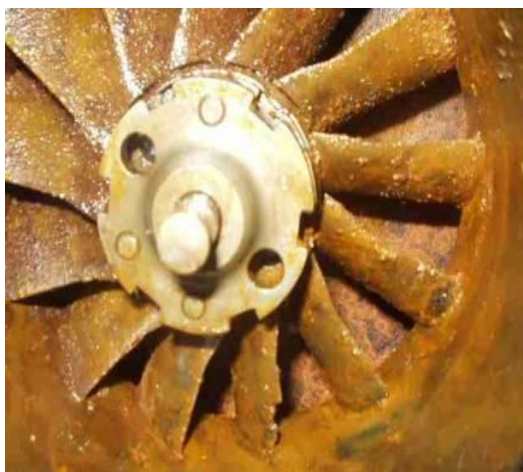
Σχήμα 6.2 Χημική Διάβρωση πτερύγωσης στροβίλου
